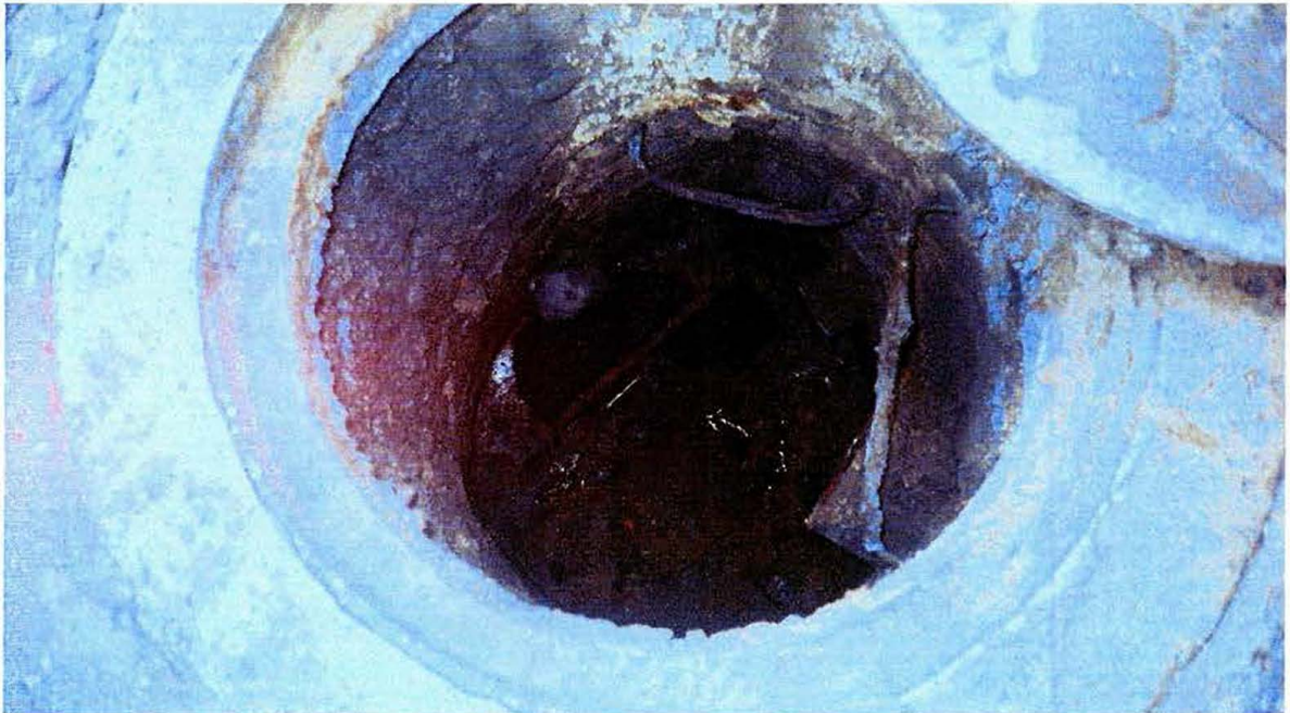
Figura 11. Pozos de inspección contruidos en ladrillo sin impermeabilización.
