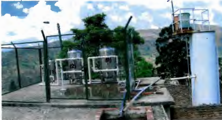
Figura 7. Planta de potabilización
