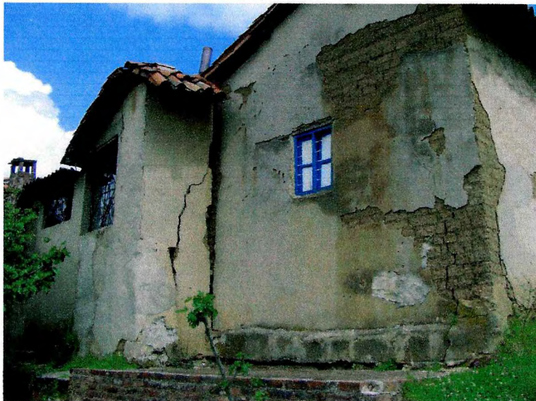
Figura 4. Fracturamiento de vivienda causado por fenómeno de Reptación.
