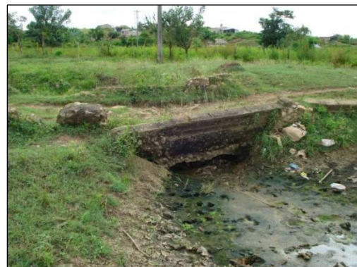
Foto Estructura de paso, puente en mal estado, erodado y fallado por obstrucción.
