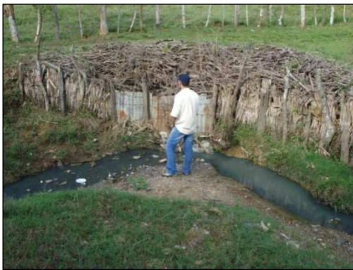
Foto Erosión de paredes del canal. Trabajos realizados por la comunidad, para proteger sus paredes. Terrenos de los Hermanos Román.
