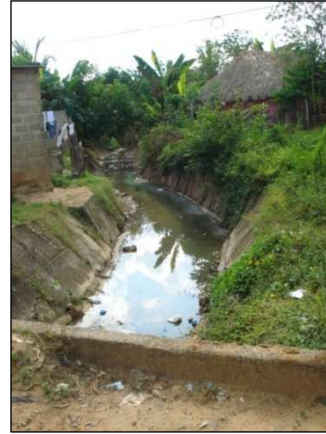
Foto. Arroyo el Desorden. Sitio afectado por inundación. Barrio San Marcos. Calle 11ª con Carreras 13.
