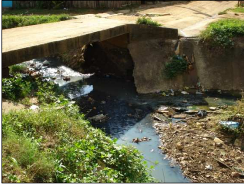
Foto. Estructura de paso deteriorada por socavación. Barrio San José.
