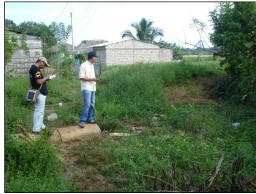
Foto. Alcantarilla de doble tubo en concreto con diámetro de 0.60, barrio San Gabriel
