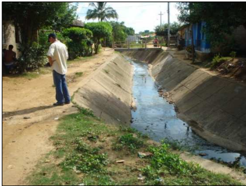
Foto. Arroyo el Desorden, sitio de inundación. Barrio San José.
