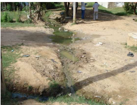
Foto. Agua residual que drena por las calles, causando erosión hídrica, y con el incremento de las lluvias inundación, no hay pavimento en la vía y se generan surcos sobre el terreno. Barrio Palma Soriana.
