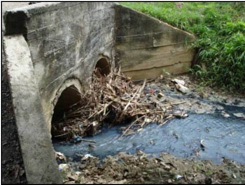
Foto Obstrucción de alcantarilla por desechos vegetales y basuras
