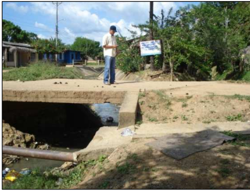
Foto. Estructura tipo Box, Punto de intersección de los canales y sitio de inundación. Se observa tubo metálico transversal que contribuye al taponamiento de la estructura. Barrio San José. Altura de la lámina aprox. 0.6 m sobre el nivel del puente..
