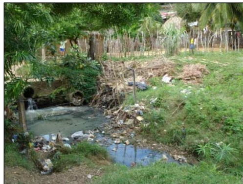
Foto Obstrucción de tubería por residuos sólidos y acumulación de los mismos en la sección del canal. Barrio Bolívar
