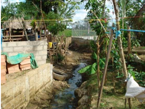
Foto. Canal de evacuación aguas abajo. Barrio Palma Soriana.
