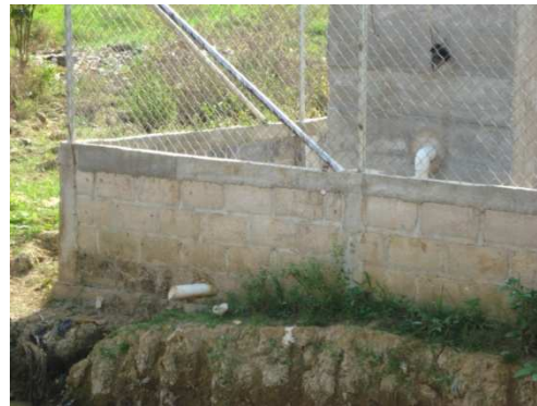
Foto. Estación de bombeo aguas residuales. Barrio Palma Soriana
