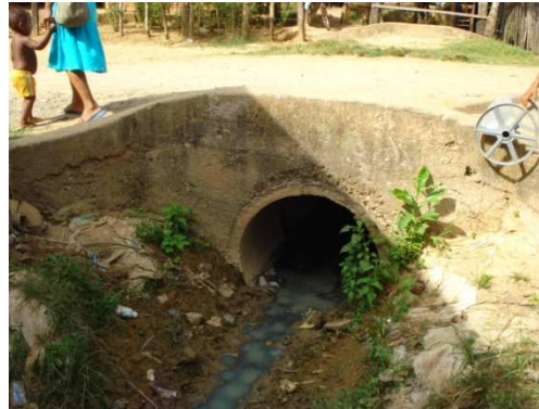
Foto. Alcantarilla en tubo e concreto d = 0.6 m. Barrio Palma Soriana.
