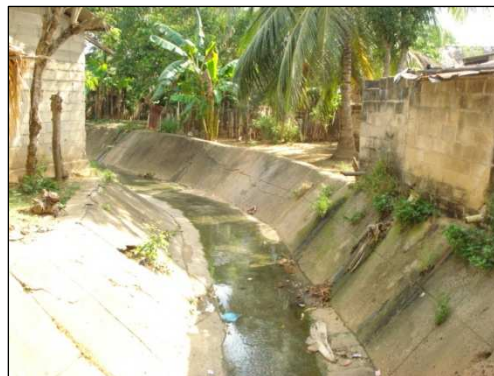
Foto. Sitio en donde el arroyo el Desorden inunda y afecta las viviendas en el barrio San José.
