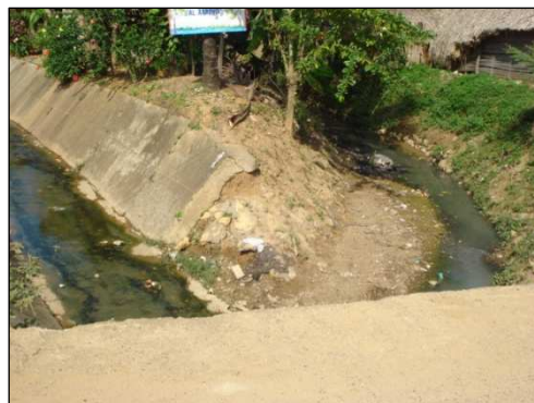
Foto. Punto de intersección de los canales y sitio de inundación. Barrio San José. Altura de la lámina aprox. 0.6 m
