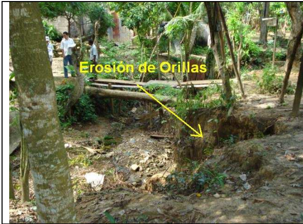
Foto. Erosión de orillas, Barrio La Inmaculada
