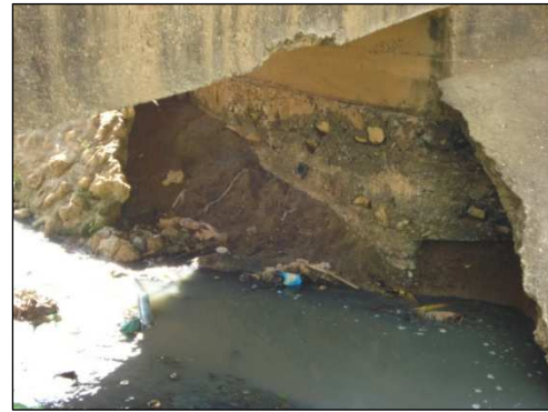
Foto. Detalle socavación estructura de paso. Barrio San José.
