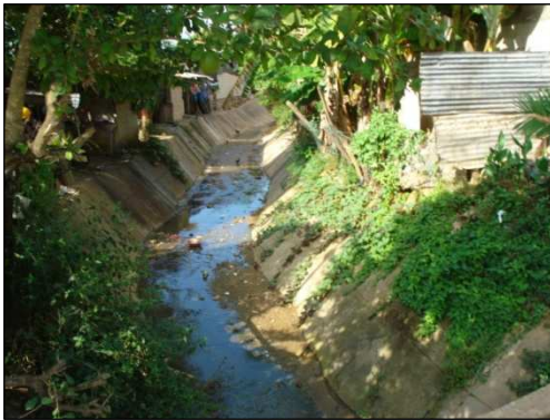
Foto. Arroyo el Desorden. Sitio afectado por inundación. Barrio San Nicolás. Calle 12 entre Carreras 12 y13..
