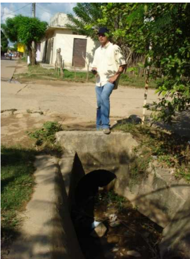
Foto. Punto donde comienza el arroyo el desorden, en sección trapezoidal, paralelamente a la fachada del antiguo Albergue Infantil. Carrera 16 con Calle 20
