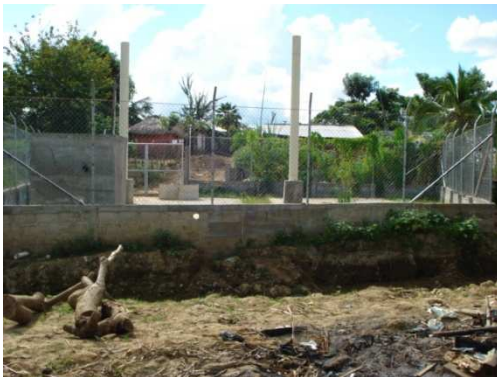
Foto Tubo de evacuación aguas residuales. Estación de bombeo. Barrio Palma Soriana.
