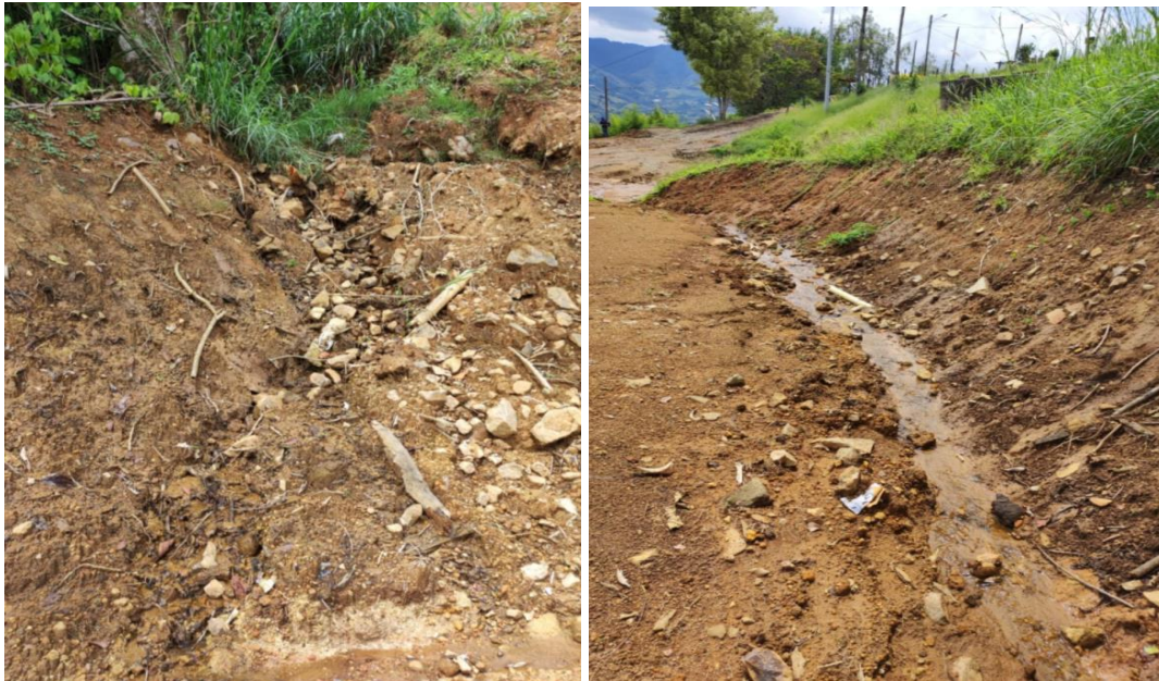
Figura 250. Camino de flujo de agua asociada a escurrimiento del talud - P4
