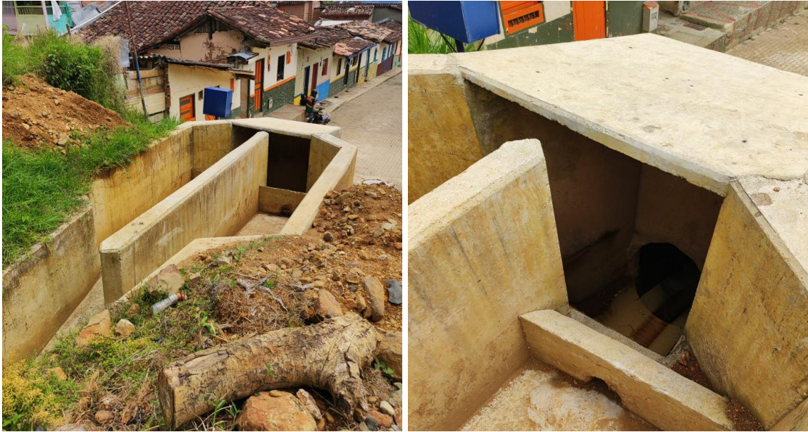
Figura 253. Obra de amortiguación de creciete de la Q. La Comba en la entrada al sistema de alcantarillado - P6.
