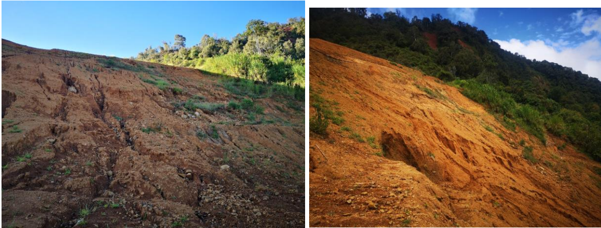
Figura 93. Procesos erosivos sobre taludes intervenidos en el sector Los Aguacates.
