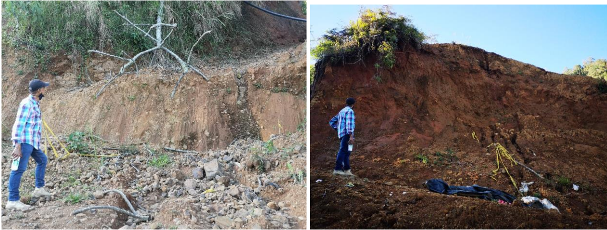
Figura 95. Escarpe identificado en la corona y el flanco occidental del movimiento en masa.
