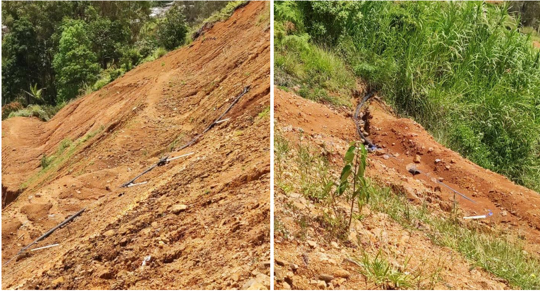
Figura 249. Obras para el manejo de las aguas lluvias en el proceso de estabilización de los taludes – P3.
