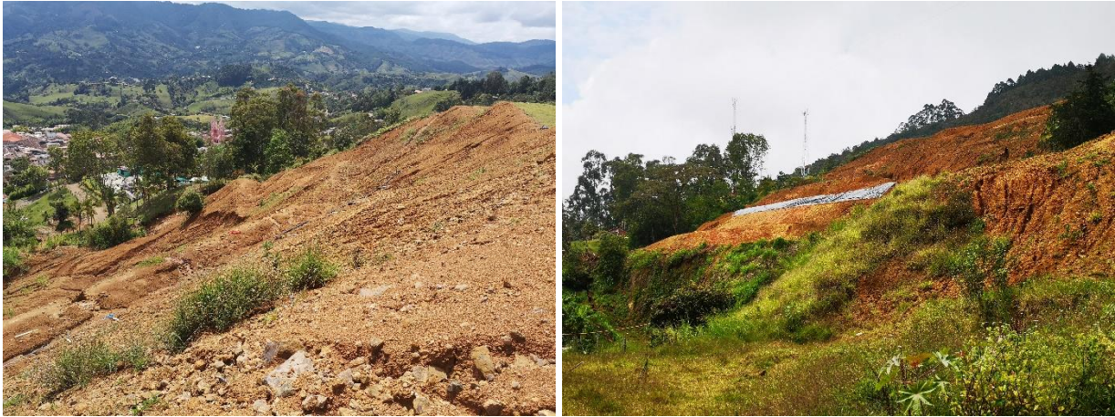
Figura 65. Rango de pendientes de 40 - 60% hacia a taludes generados en construcción de obras de mitigación
