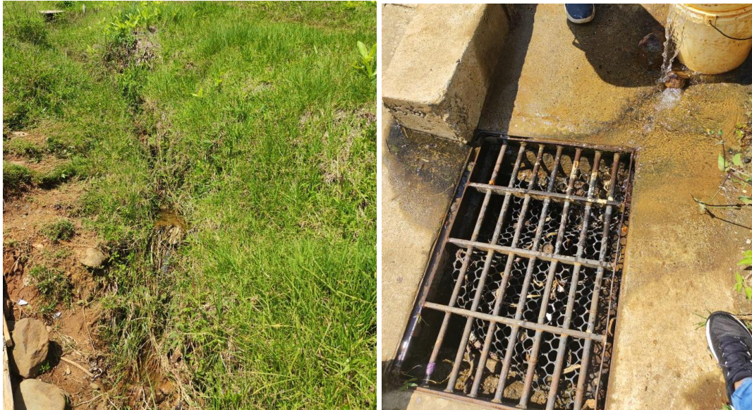
Figura 251. Drenaje existente asociado al escurrimiento de la ladera - P5.
