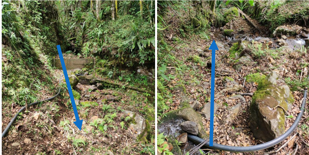
Figura 256. Obra de captación de agua Q. La Peña bifurcación margen izquierda – P9.
