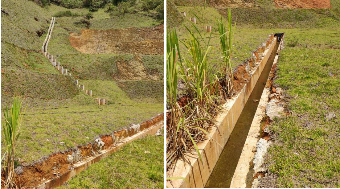
Figura 247. Obras de conformación del talud y manejo de las aguas lluvias – P1.
