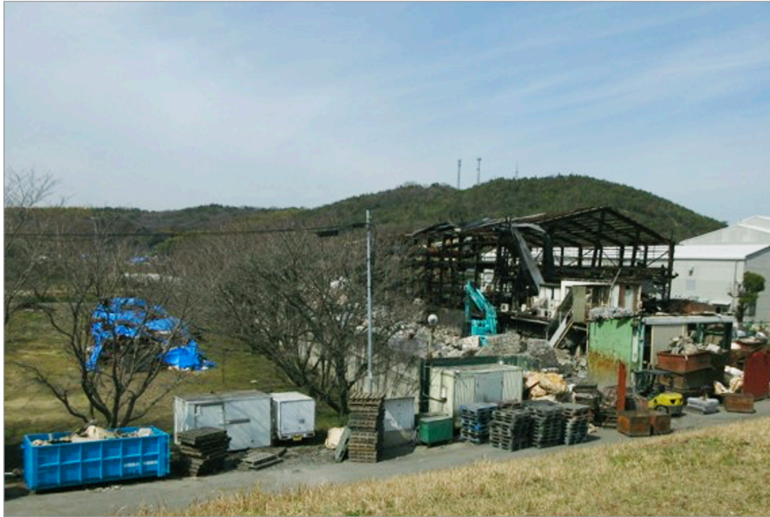
a) Afectaciones en la fábrica de aluminio por la explosión
