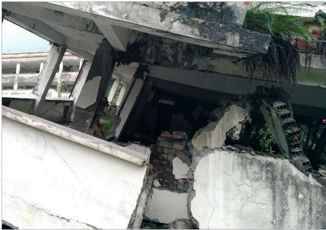
Figura 6. Afectaciones en infraestructura por el terremoto de Wenchuan. Fotos: María Camila Suárez Paba.
