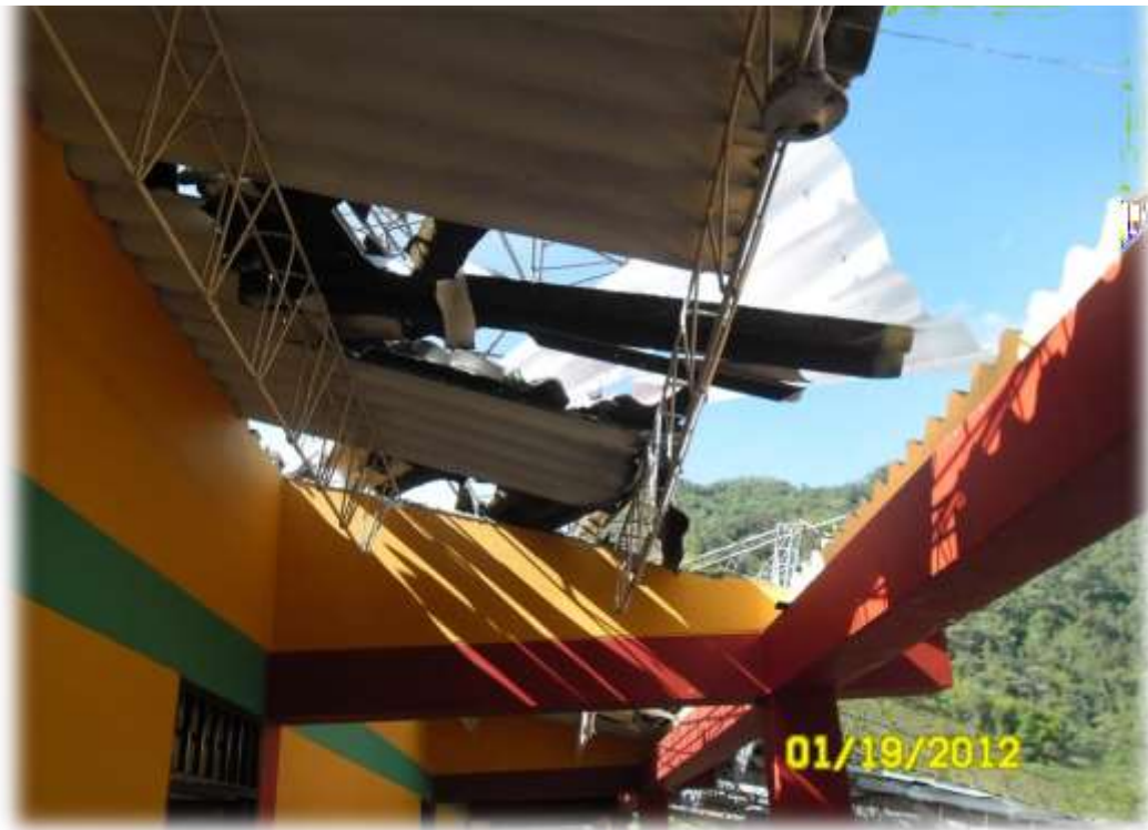
FIGURA 5: AFECTACIÓN POR VENDAVALES
