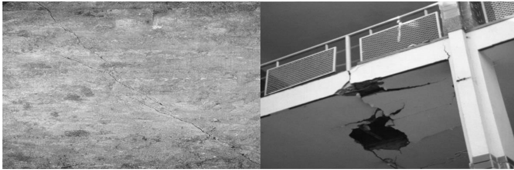
a) Daño leve
