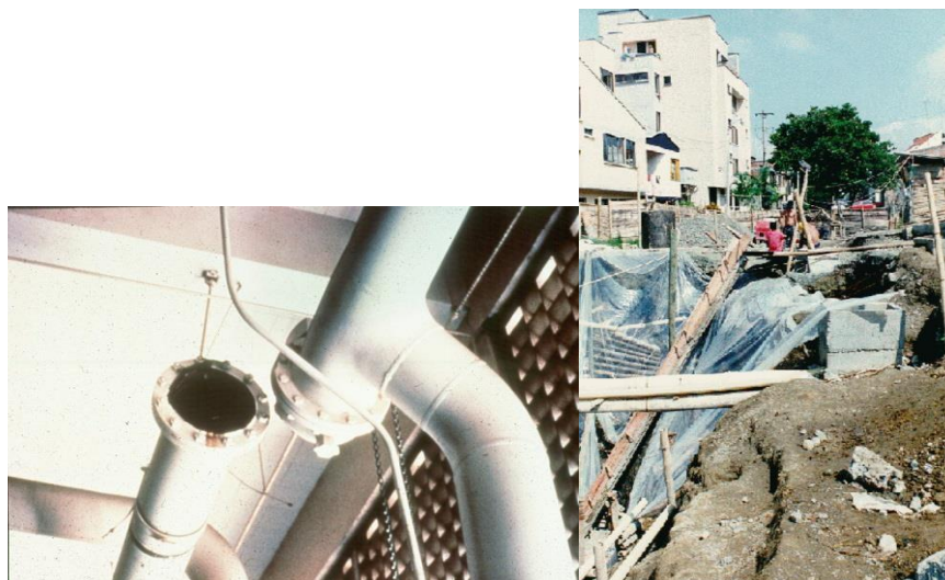
Fotografía 3-31. Daños severos en instalaciones de acueducto y alcantarillado
