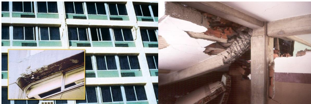
c) Daño fuerte
