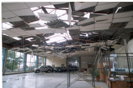
Fotografías 3-25. Daños en cielos rasos y luminarias
