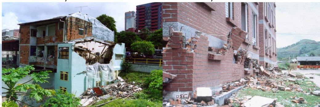
c) Daño severo
