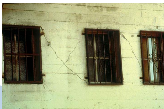
a) Daño moderado
