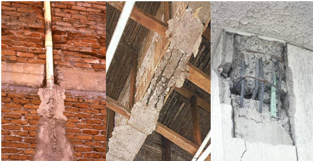
Fotografías 3-33. Ejemplos de mala calidad en la construcción
