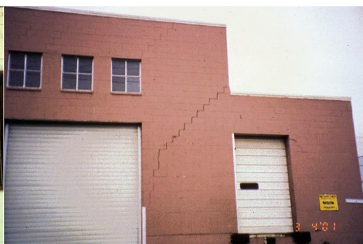
b) Daño moderado
