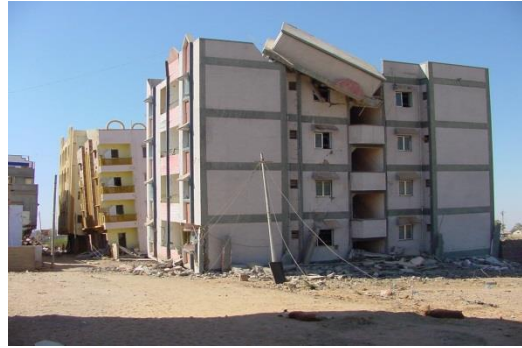
Fotografía 3-28. Daño severo en tanque elevado
