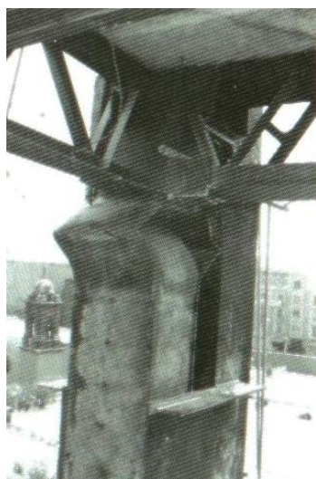
c) Daño severo
