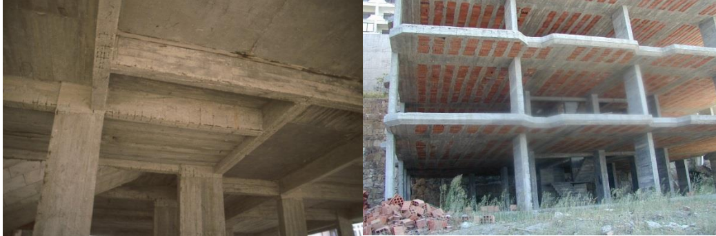
Fotografías 3-34. Fallas en la configuración estructural
