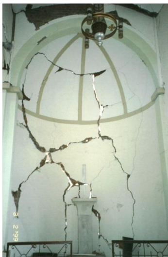
e) Daño severo
