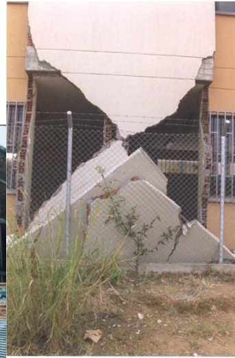
f) Daño severo
