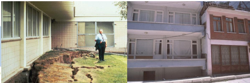
Fotografías 3-10. Fallas en el suelo de cimentación
