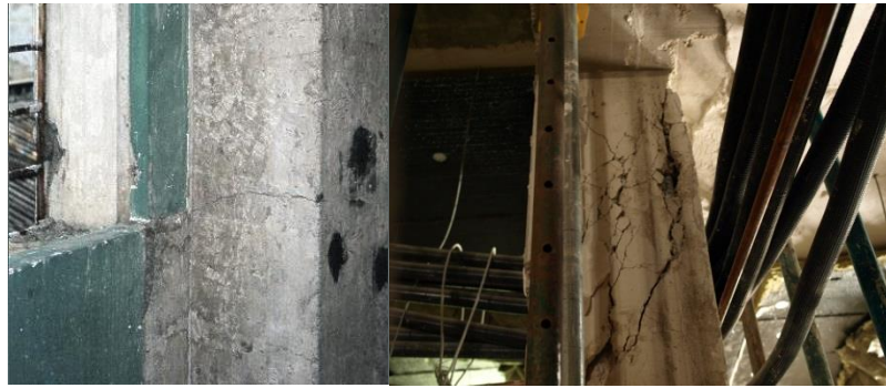
a) Daño leve
