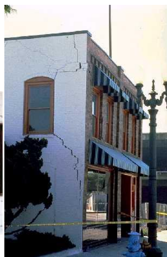
b) Daño Fuerte
