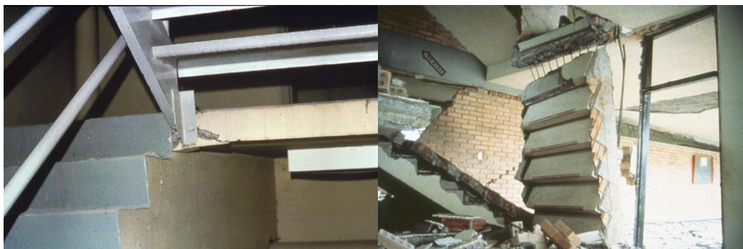
Fotografía 3-27. Daño moderado y severo en escaleras
