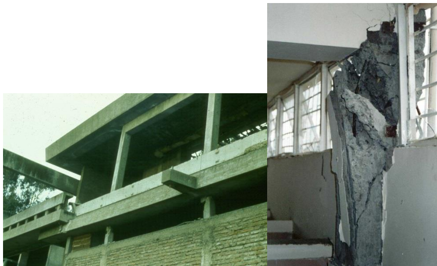
Fotografía 3-35. Falla por efecto de columna corta
