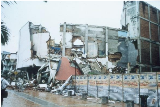
e) Daño severo
