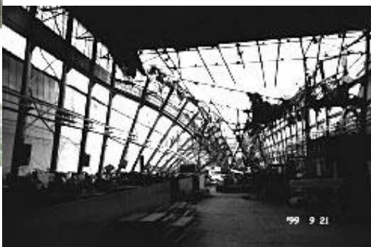
d) Daño severo
