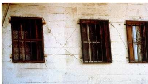
a) Daño Moderado
