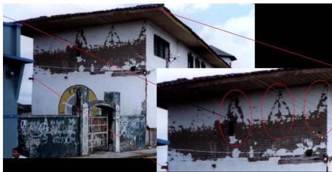
a) Daño moderado
