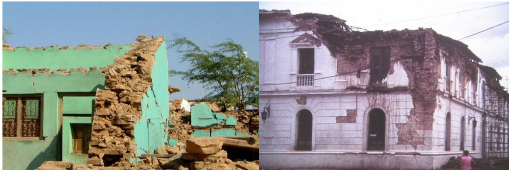
Fotografías 3-15. Daños severos en muros de tapia
