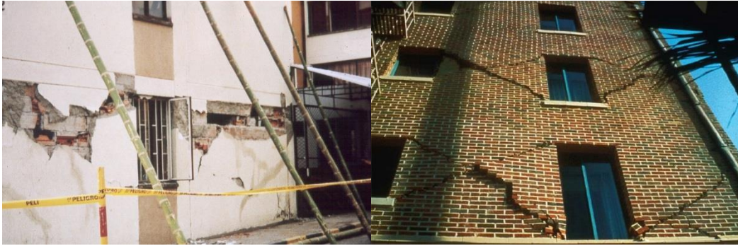
c) Daño fuerte
