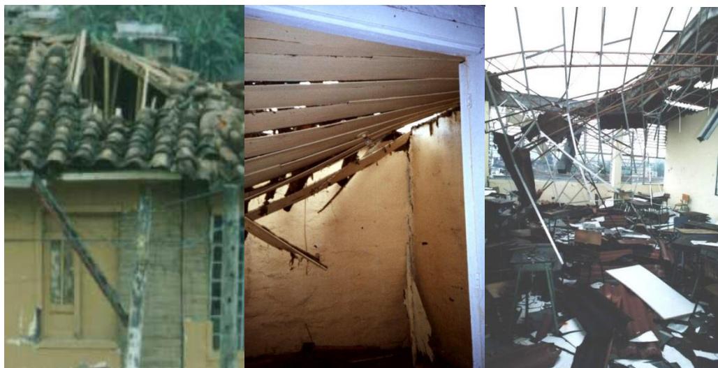
Fotografías 3-26. Daños en el sistema de cubierta
