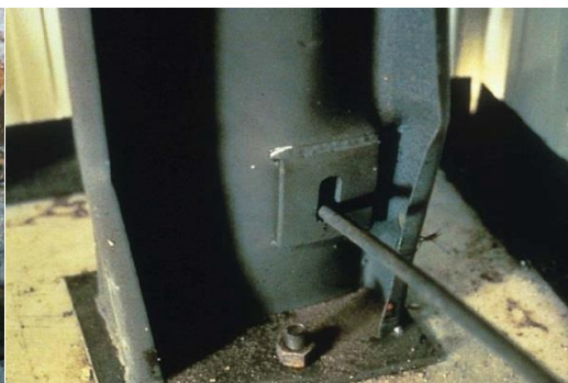
b) Daño fuerte
