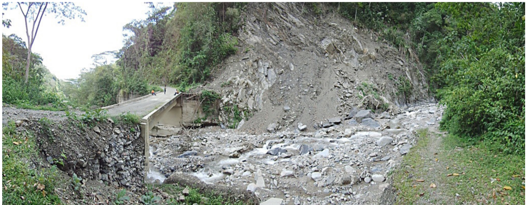
Fotografía 99. Movimiento en masa compuesto, presenta caída de roca y de detritos, municipio de Ortega (clasificación y fotografía por Jhon Jairo Porras, UPTC, 2013).
