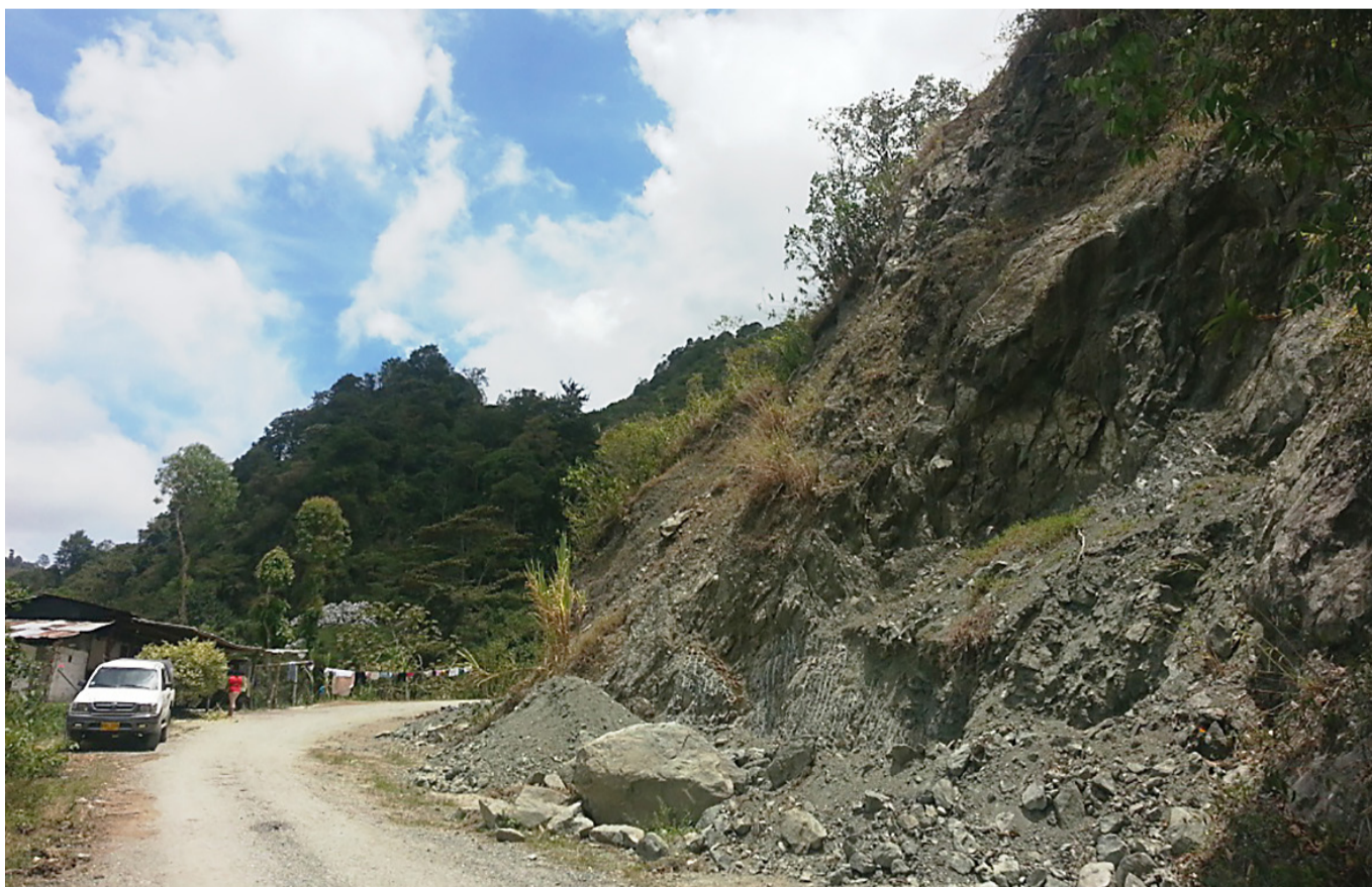
Fotografía 92. Movimiento en masa de tipo caída de roca, municipio de Génova, vereda Santa Elena (clasificación y fotografía por Luis David Mesa, UPTC, 2013).
