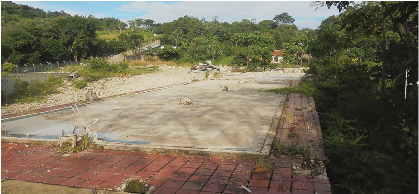
Fotografía 57. Ruinas de la planta de tratamiento de agua potable, destruida por un movimiento en masa compuesto, conformado por un deslizamiento rotacional y una caída de roca (tomada por Camilo Andrés Talero Neita, UPTC, 2014).
