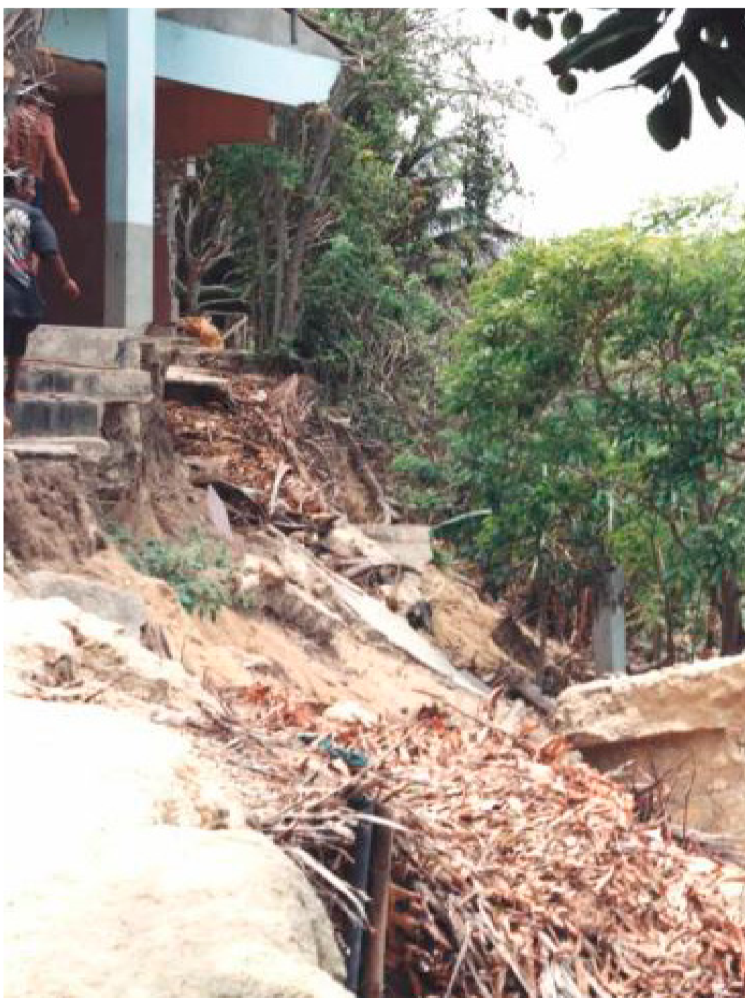
Fotografía 43. Detalle de uno de los procesos de inestabilidad en Salgar (municipio de Puerto Colombia) (tomada del estudio de Ingeominas, 1999).
