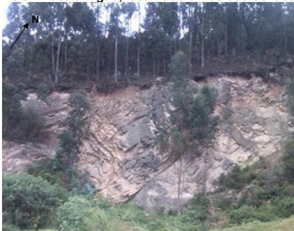
Fotografía 5.7. Movimiento en masa antiguo, localizado en las coordenadas N 1047584 y E 1007383
