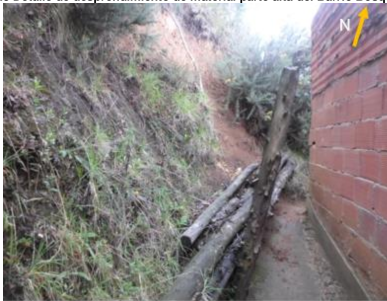
Fotografía 5.3 Detalle de desprendimiento de material parte alta del Barrió Bosques de Silena.
