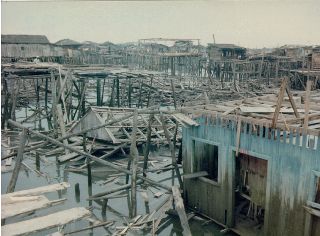
Viviendas palafíticas, especialmente en madera, aguas afuera de la playa: efectos por vibraciones sísmicas y por el tsunami que ocurrió en marea baja (menos 3,5 metros). Se observa el nivel de inundación en la casa de color azul que fue parcialmente protegida por viviendas delante de ella, sobre el mar. Tomada por Hansjürgen Meyer, diciembre de 1979.
