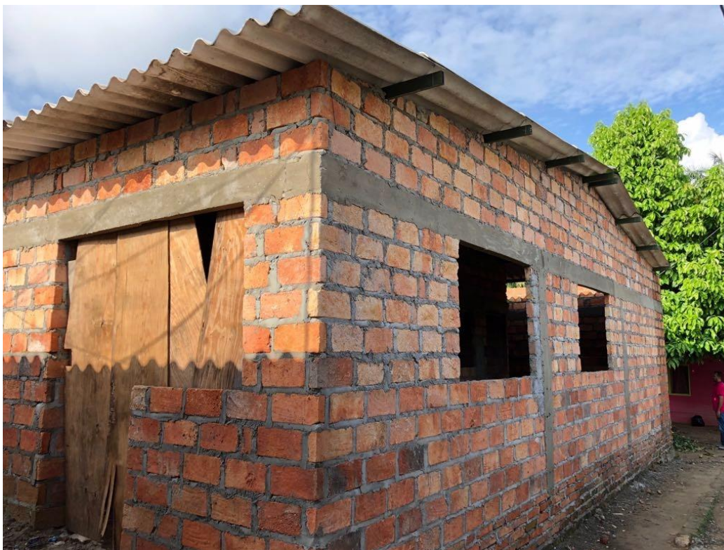
Fotografía 3.3 Mampostería confinada sin ingeniería
