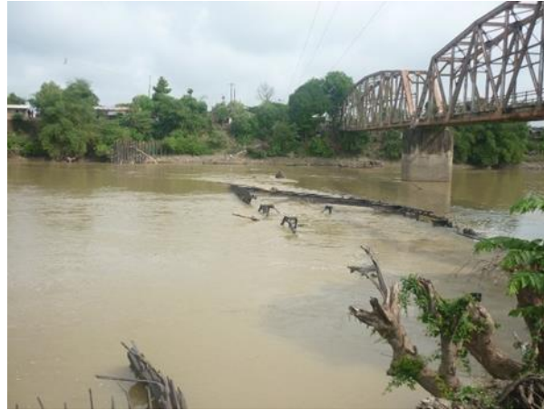
Figura.7. Erosión Lateral de Orillas ocasionada por la instalación de pilotes en el margen derecho del Río Sogamoso.
