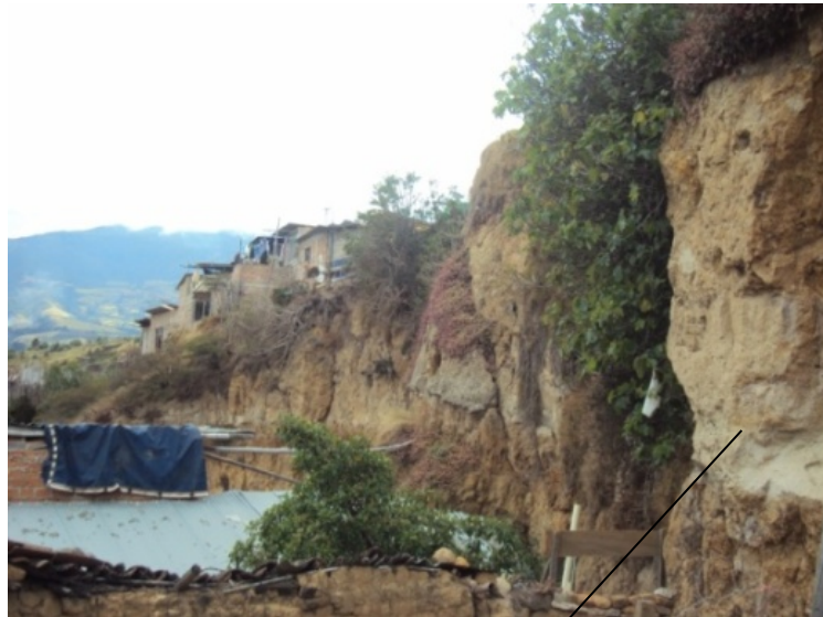
Grietas con un ancho Más de 20 cm
