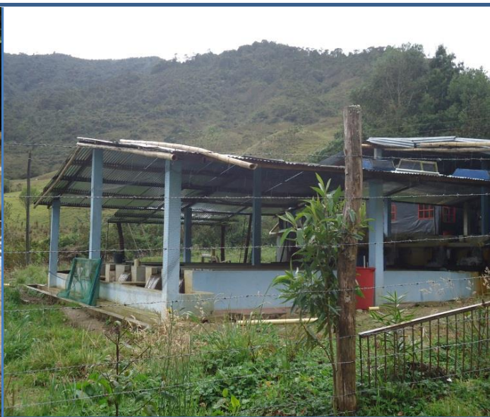
Figura 47. Vivienda afectada por socavación lateral y posibles depósitos torrenciales del Río Motilón.
