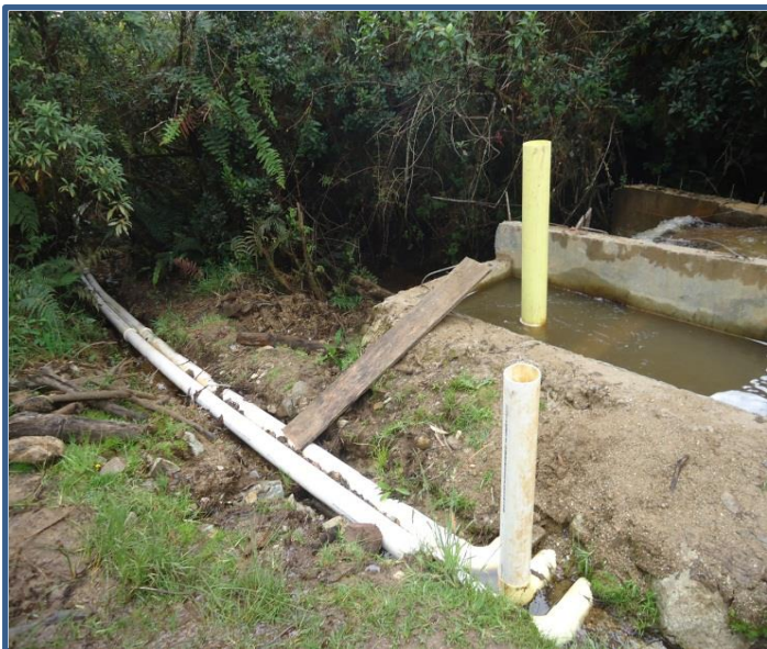
Figura 48. Bocatoma que abastece a la Vereda El Motilón ubicada hacia la parte media de la Microcuenca.
