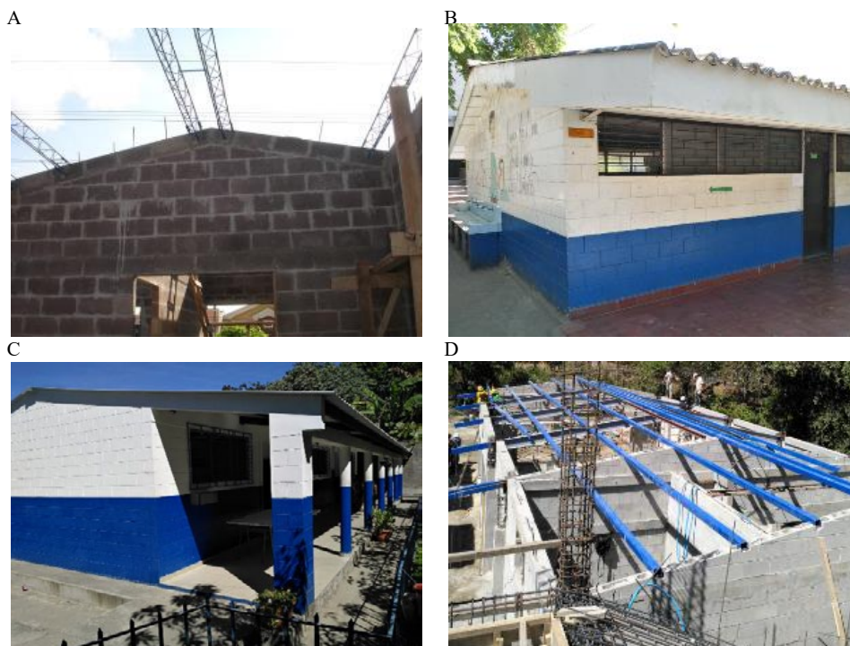
Figura 10. Ejemplos de edificaciones de mampostería reforzada. (A) Edificación escolar en Colombia. (B) Edificación escolar en El Salvador. (C) Edificación escolar en El Salvador. (D) Edificación escolar en construcción en El Salvador. Fotos tomadas del GPSS y del archivo personal de los autores.
