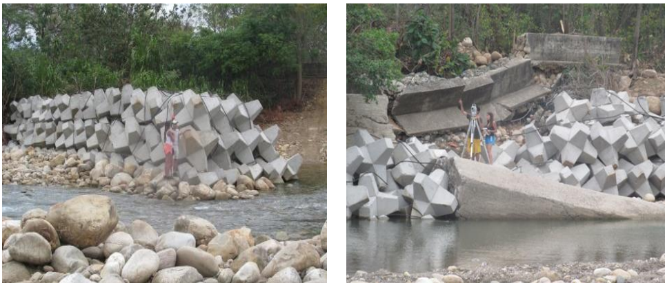
Figura 12. Estructuras hidráulicas para control de socavación en el río Unete. Trabajo de campo de topografía e identificación de estructuras hidráulicas efectuado en el río Unete en enero de 2018 (izq) y (der).
