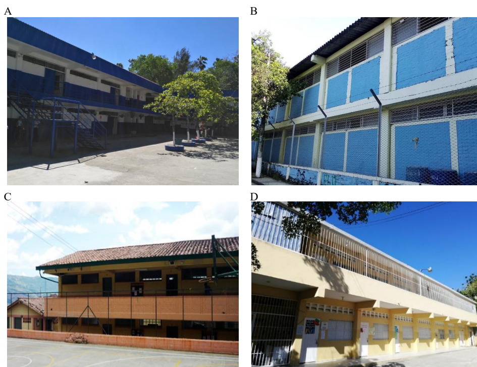
Figura 7. Ejemplos de pórticos de concreto reforzado resistente a momento con muros de mampostería generando columna corta. (A) Edificación escolar en Perú. (B) Edificación escolar en El Salvador. (C) Edificación escolar en Colombia. (D) Edificación escolar en República Dominicana. Fotos tomadas del GPSS y del archivo personal de los autores.
