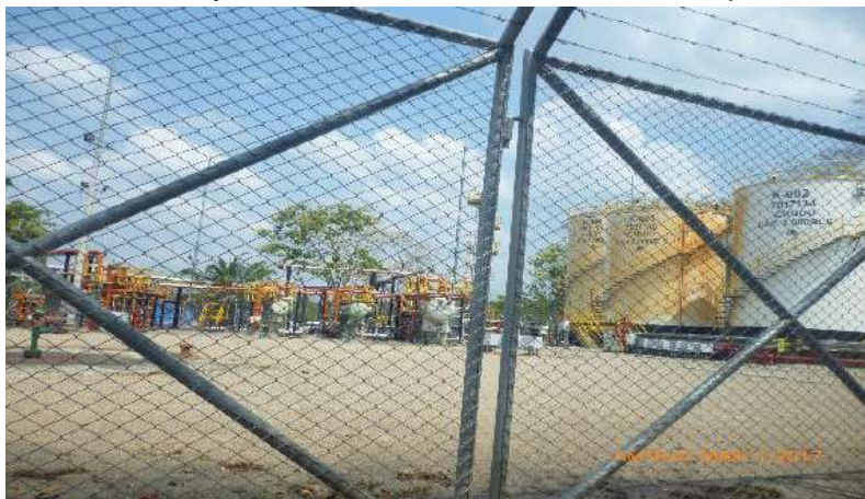
Figura 537 Área de recibo y almacenamiento de crudo Campo Bonanza
