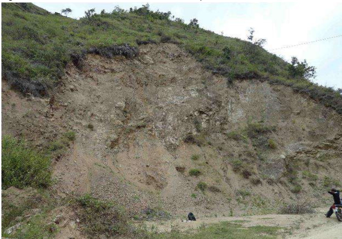
Figura 734. Deslizamiento sobre la vía al municipio de Cáchira
