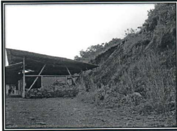
Ilustración 37: Deslizamiento en pendiente - Colegio Santa Cruz
