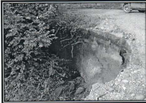
Ilustración 36: Desprendimiento de banca sector Méndez
