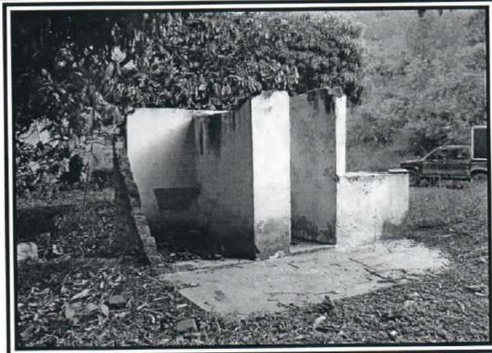
Fuente: registro fotográfico trabajo de campo Ilustración 23 : Deslizamiento que causó Desplome de vivienda y 3 muertos en el año 2012
