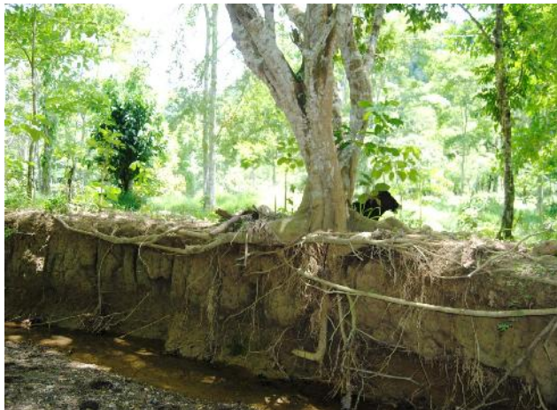
Fotografía 26 Vereda Tacanal abajo: Deslizamiento
