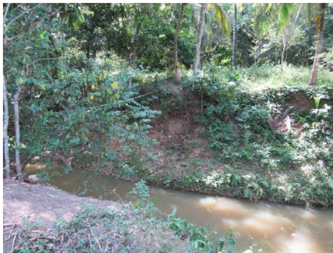
FOTOGRAFÍA 6. PROCESO INCIPIENTE EN LA MARGEN DERECHA DE LA QUEBRADA EL PIRÚ, PÉRDIDA DE MATERIAL Y VEGETACIÓN POR INTERVENCIÓN ANTRÓPICA
