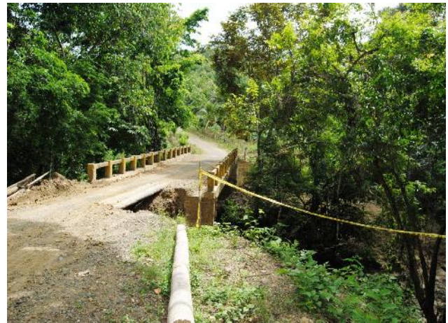
Fotografía 25 Puente Tacanal abajo: Socavación lateral margen. izquierda de la quebrada
