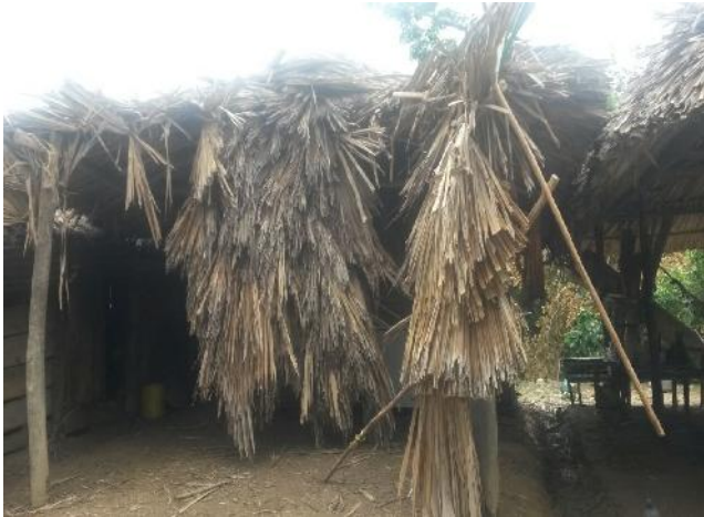
Fotografía 17 Fotografía vivienda destechada consecuencia vendavales y fuertes brisas vereda San Jacinto. Julio de 2015
