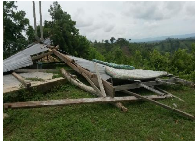
Fotografía 18 Vivienda destruida efectos de vendaval y/o brisas huracanadas. Julio 2015
