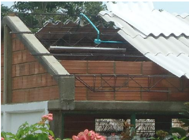
Fotografía 19 Fotografía IE Arenas Monas destechada consecuencia vendavales y fuertes brisas. Agosto de 2013
