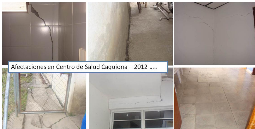
Foto No. 1: Afectaciones en centro de salud del resguardo de Caquiona
