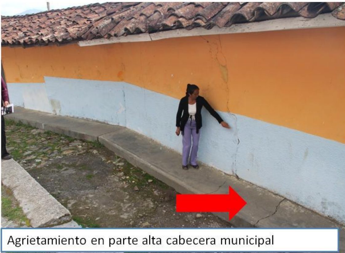
Amenaza viviendas Parte alta Cabecera Municipal
