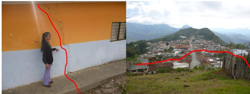
Foto No. 5: Agrietamientos parte alta cabecera municipal barrio Fátima en suelo, piso y paredes de las viviendas.
