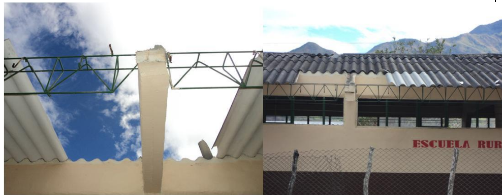
Foto No. 8: Daños en cubierta de la escuela Palizada Elevecia – municipio de Almaguer por vendaval
