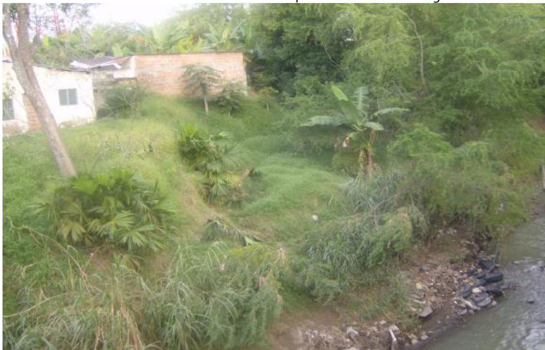
Fotografía 10. Falla por vertimientos de agua y pérdida de vegetación en la ribera Rio Apartadó.
