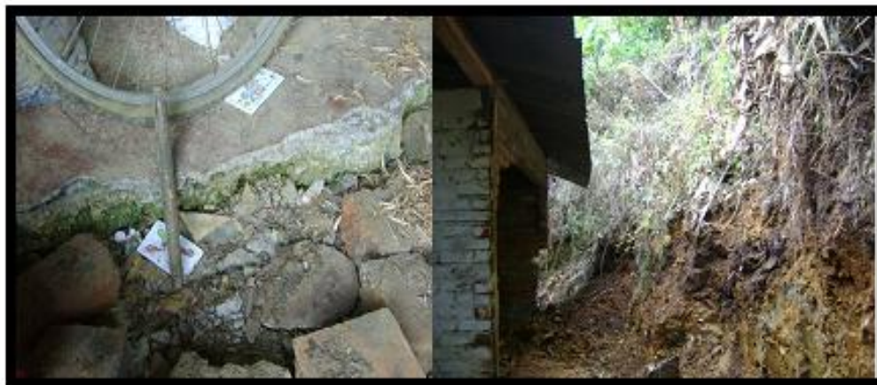
Foto 9. Desplazamiento - hundimiento de piso, deslizamiento sector la Colonia
