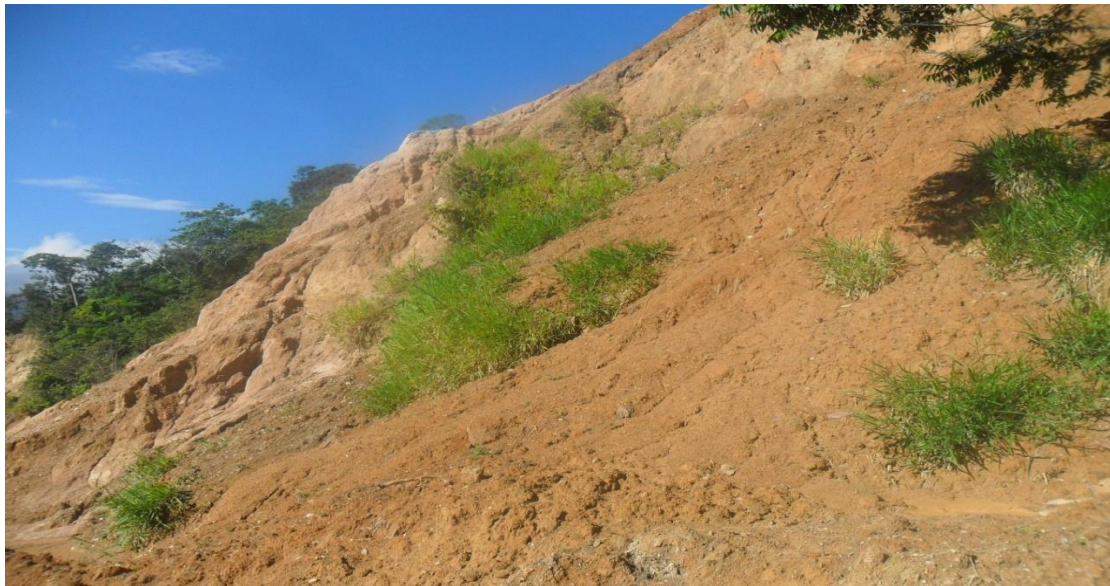
Movimiento en masa que obstaculizo la vía que del corregimiento de mesitas conduce hacia el casco urbano del municipio de Hacarí.
