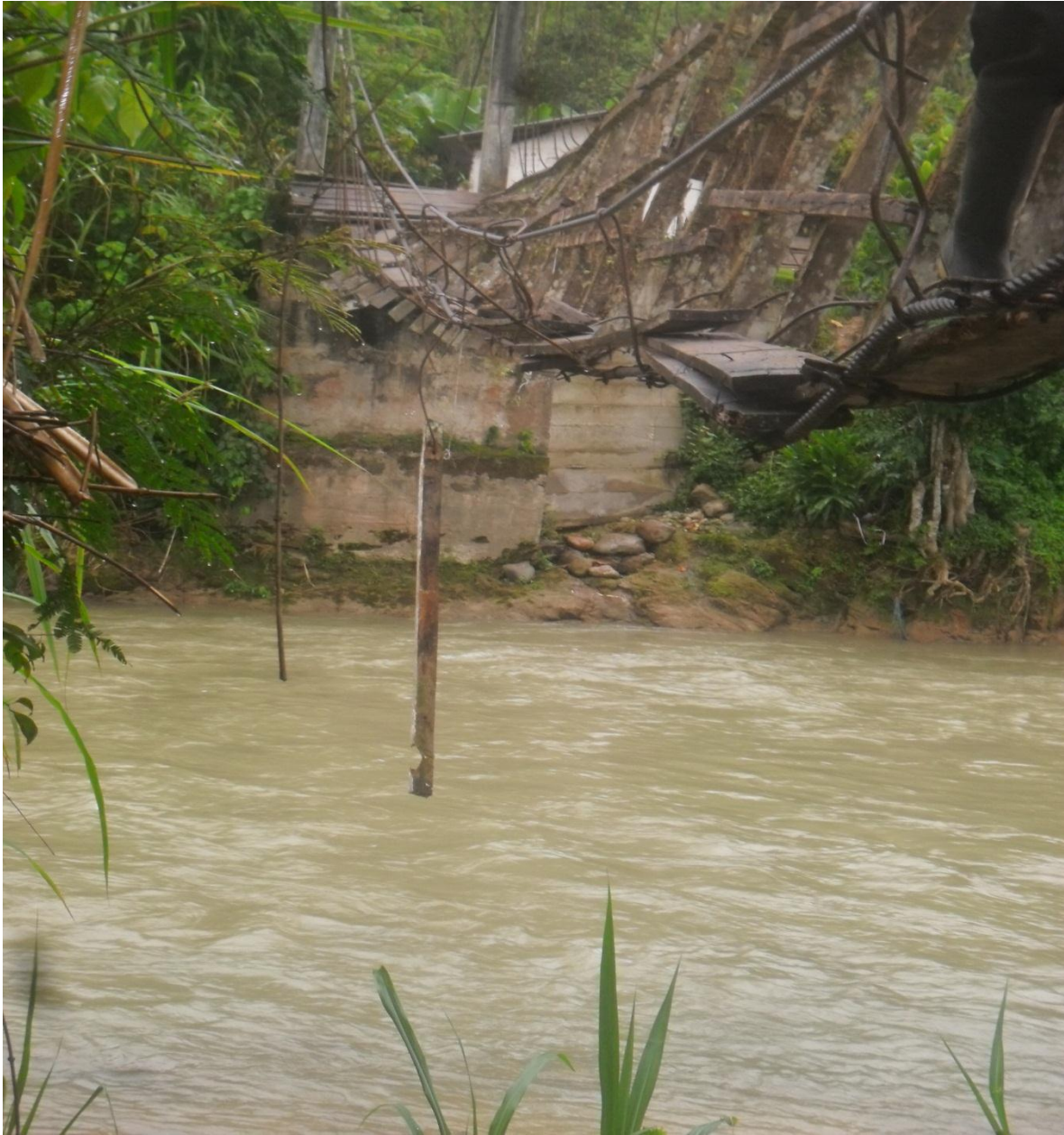
Podemos observar la magnitud del daño presente en este puente hamaca
