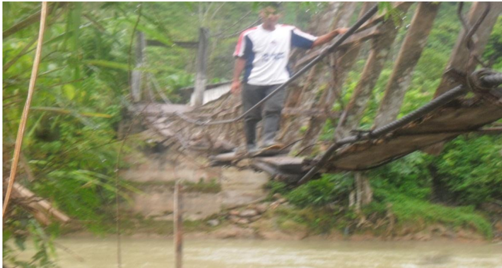
Puente hamaca destruido.
