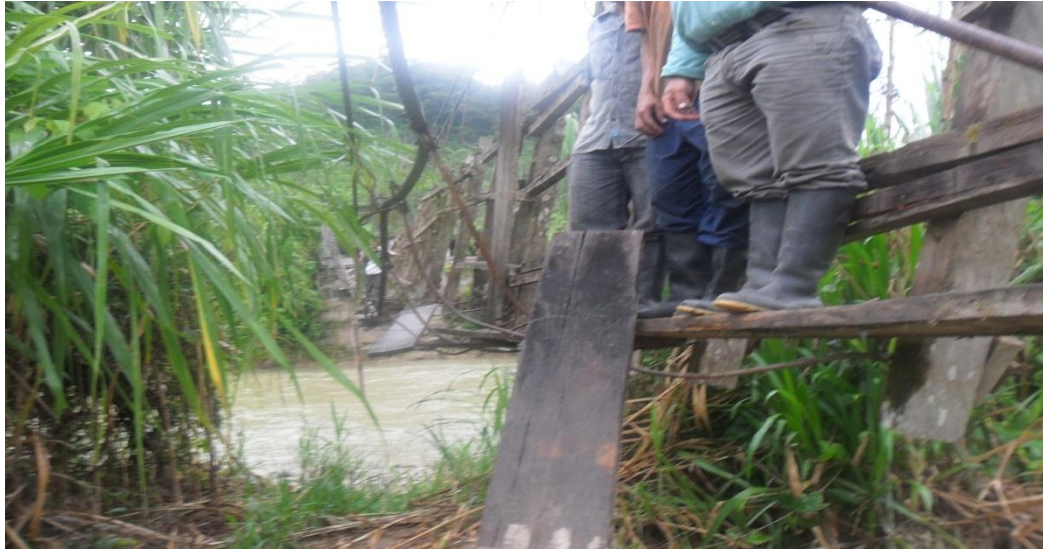
Puente hamaca destruido.
