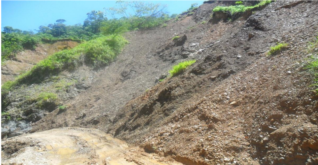
Derrumbes en la vía que conduce al corregimiento de mesitas.
