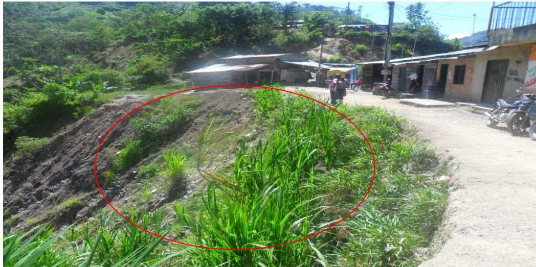
margen izquierda se derrumbó por fenómenos de origen natural geológico.
