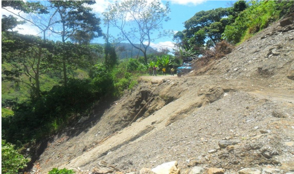
Vías del sector rural obstaculizadas por fenómeno de remoción en masa
