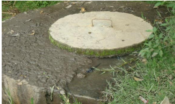
Figura 31. Colapso alcantarilla Vereda salado Blanco. (Por: Fabián Belalcázar)
