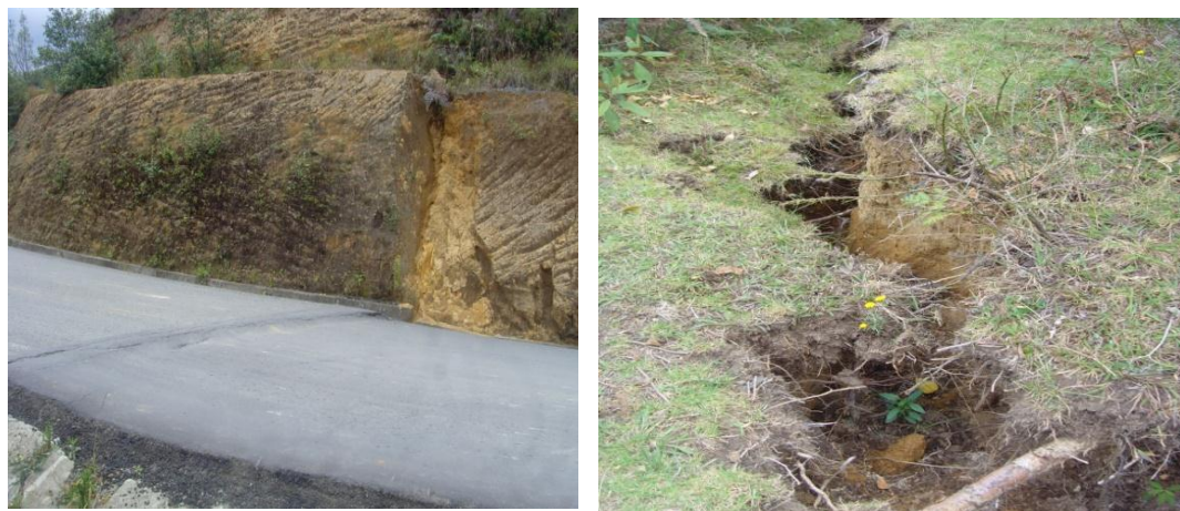
Figuras 37 y 38. Efectos por Falla Geológica-vía Popayán –Totoró. (Por: Harold R.)
