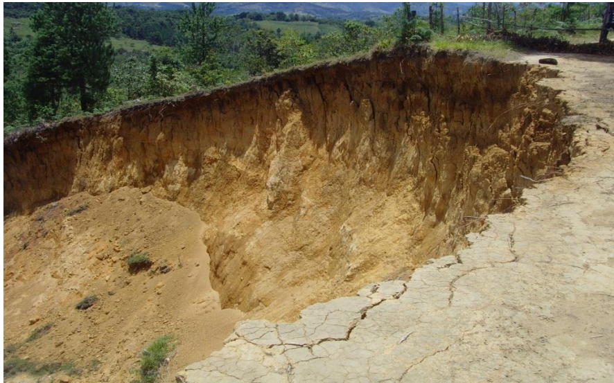
Figura 33. Vereda San Cristóbal-deslizamiento sobre el camino Veredal. (Por: Harold Ruano)
