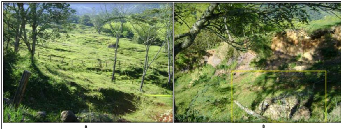
Fotografía 12 – Zona en reptación y muro de gaviones volcado (Quebrada La Tigra).
