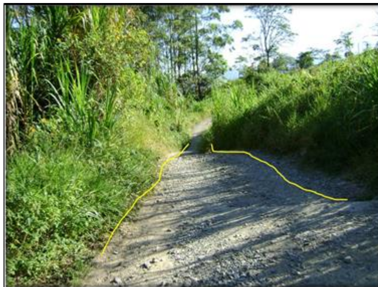
Fotografía 11 – Desplazamiento de la vía por reptación en el terreno.
