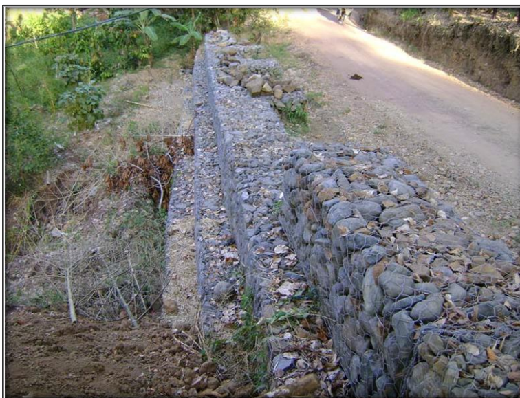
Fotografía 8 - Obra para recuperación de la banca de la vía en la quebrada La Sucia
