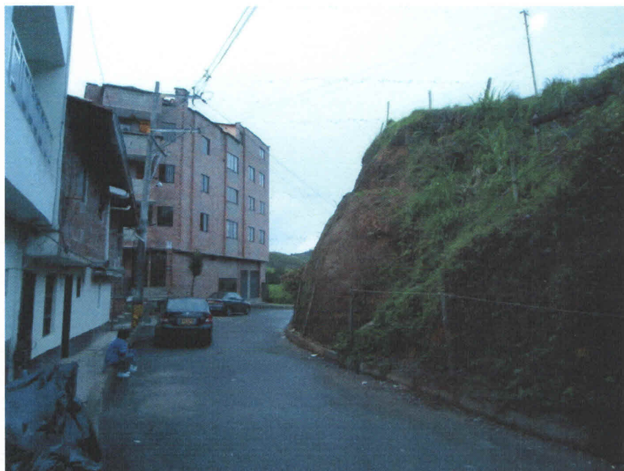
Barrio el Totumo. Talud en amenaza alta por movimiento en masa
