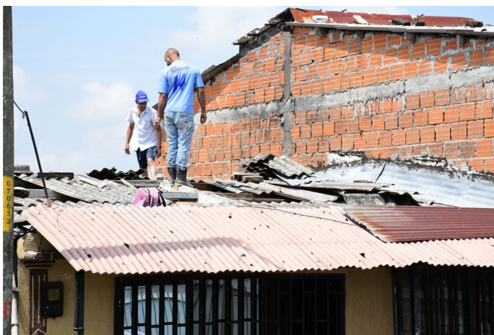
Figura 8. Viviendas con afectaciones. Fuente: El Diario del Otún (10 de marzo de 2019).
