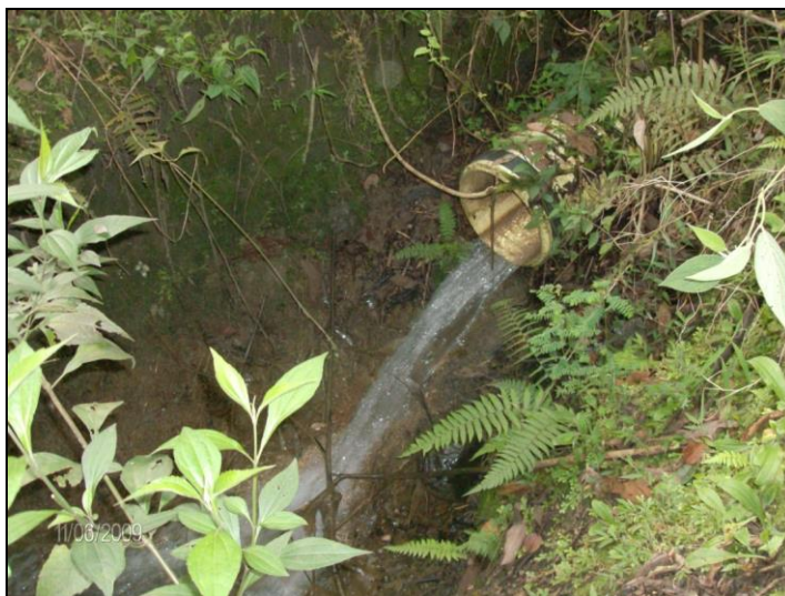
Foto 46. Vertimiento directo sin tratamiento a la quebrada Grande.
