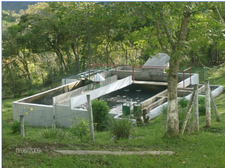
Foto 42. Planeación Ecológica Ltda. -Planta de tratamiento de agua del acueducto central del casco urbano.
