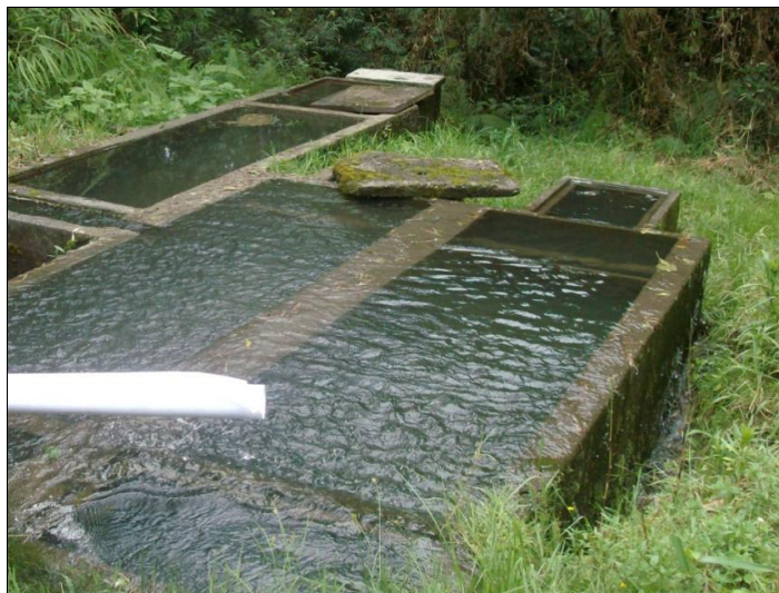
Foto 40. Planeación Ecológica Ltda. -Bocatoma del acueducto central del casco urbano.
