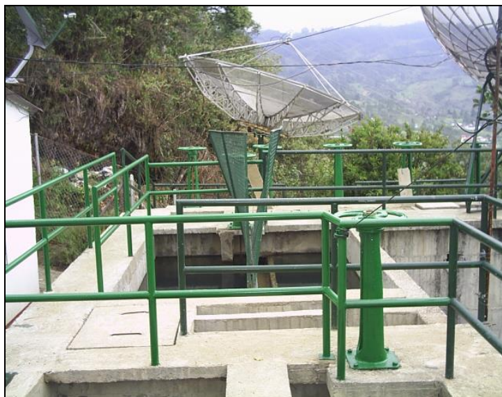
Foto 43. Detalle de la planta de tratamiento de agua del acueducto central del casco urbano. Fuente: Corpoguavio, 2006.
