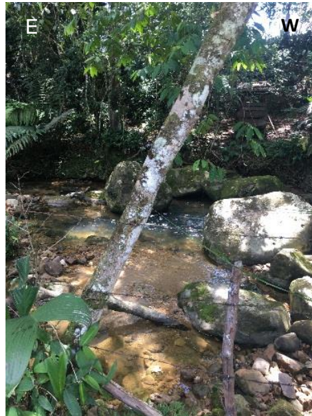
Fotografía 28. Orillas inclinadas hacia la margen derecha de la Quebrada Gazajujo; se observa socavación lateral. Coordenadas: 4° 38'56'' N, 73°19'31'' O, h 770 m.
