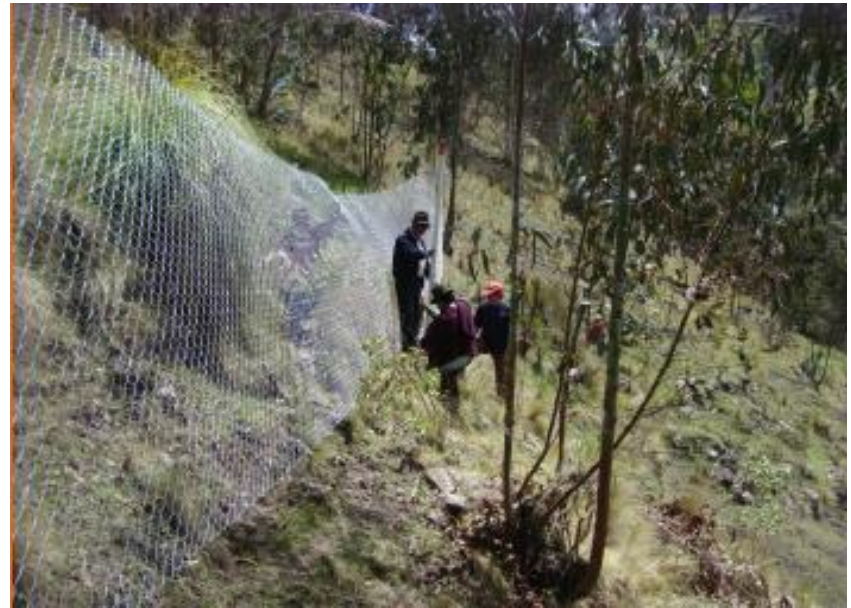
Foto 10. Malla de control de caída de rocas. Fuente:Guía de Sistemas De Alerta Temprana por deslizamientos Proyecto Sinchi Runa El Chimborazo- Ecuador. Comisión Europea VI Plan- DIPECHO. 2010.
