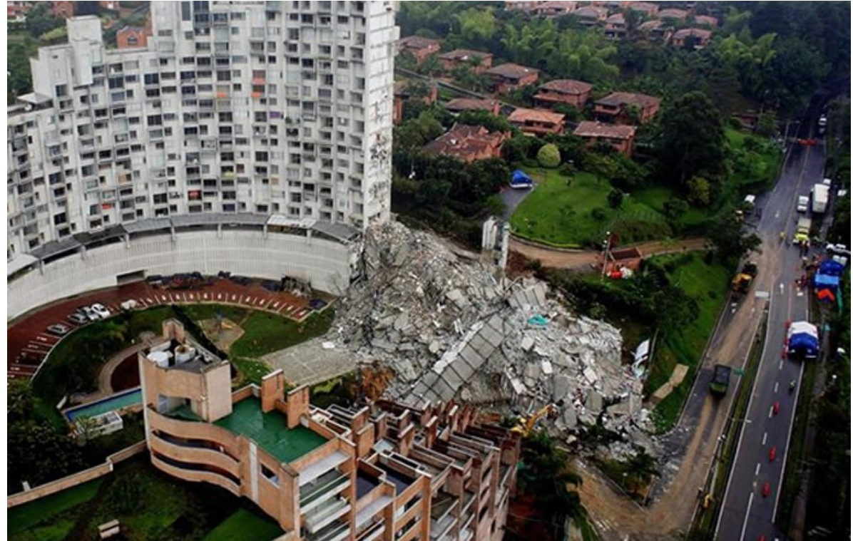
Colapso del edificio Space en Medellín (Antioquia)
