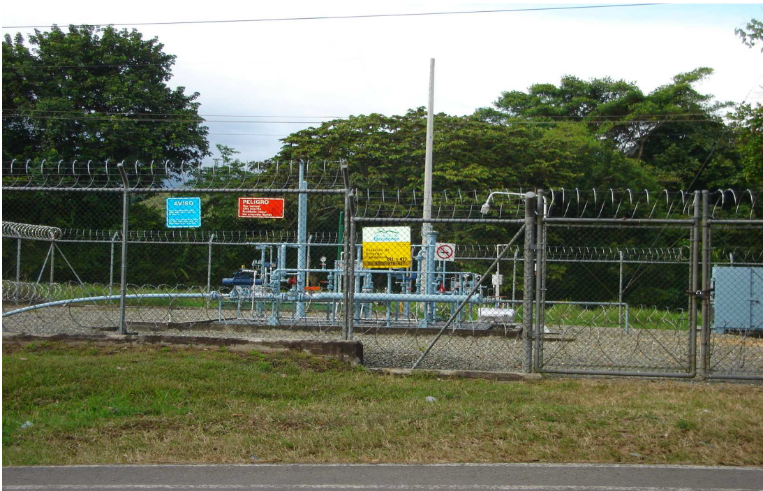
Fotografía 48. Transporte de hidrocarburos, gasoducto de occidente (Equipo Operativo)
