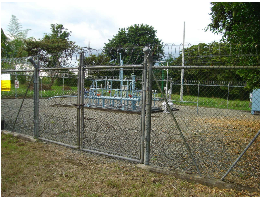
Fotografía 31: Infraestructura para transporte de hidrocarburos (Equipo Operativo)
