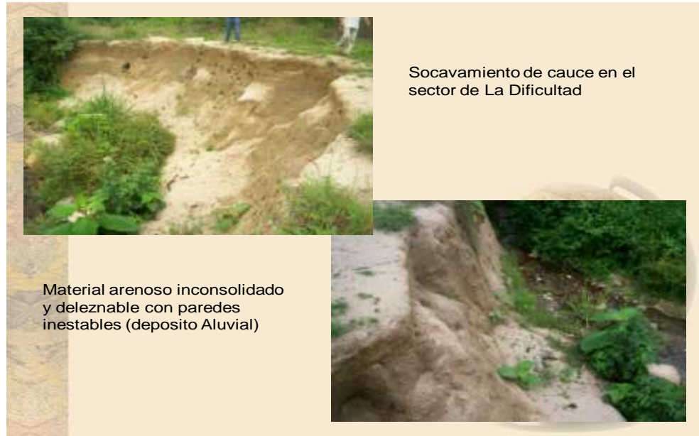
Figura 38 Sedimentación y socavamiento por sedimentación
