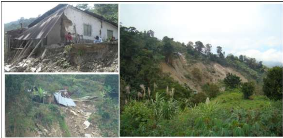
Fotografía 2.4.8. Vivienda afectada en el sector Santa Rosa.
