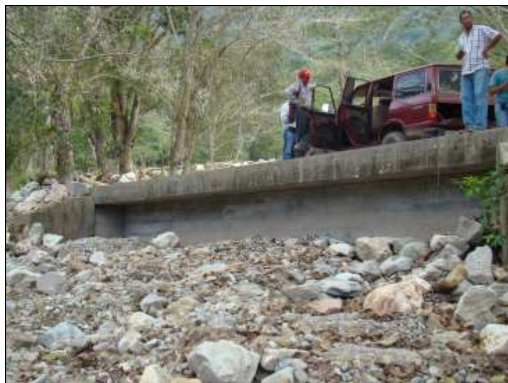
Fotografía 2.4.9. Vía de acceso a Manaure Balcón del Cesar puente afectado por el fenómeno de remoción en Masa.
