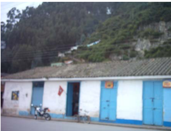
Nemocón: Vivienda antigua y sin elementos sismo resistentes.
