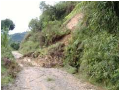
Figura 49 Desestabilización de taludes vereda San José
