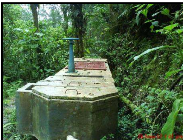
Figura 138 Tanque desarenador Sistema 2 quebrada de Paramillo
