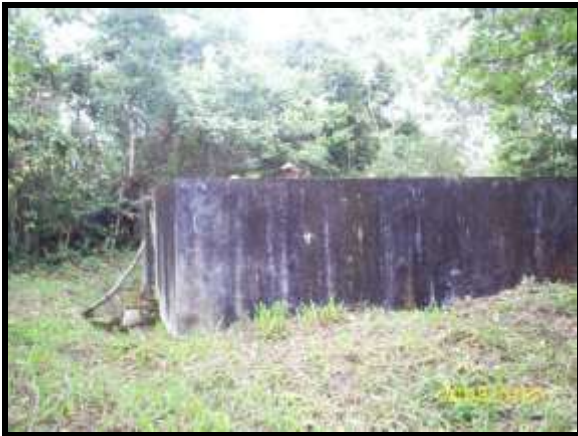
Figura 150 Tanque de almacenamiento
