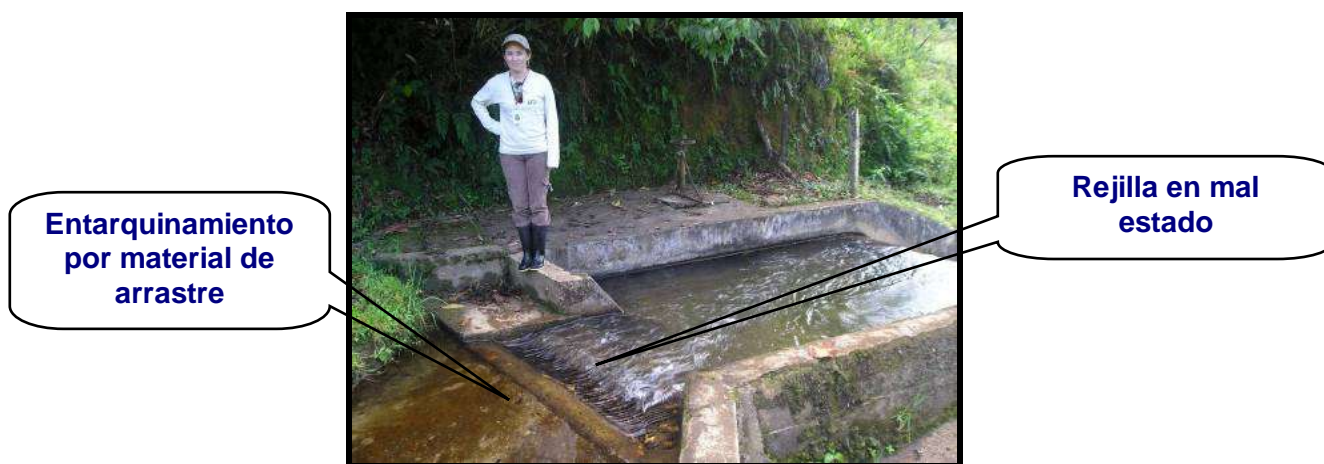
Figura 119 Detalle de rejilla en Bocatoma tipo fondo.
