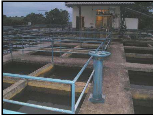
Figura 170 Planta de Tratamiento Acueducto Garzón
