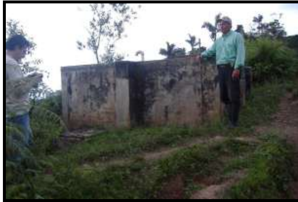
Figura 160 Tanque de Almacenamiento
