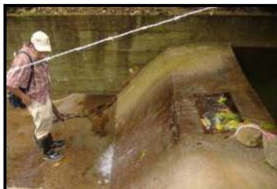
Figura 133 Detalle de rejilla de captación.
