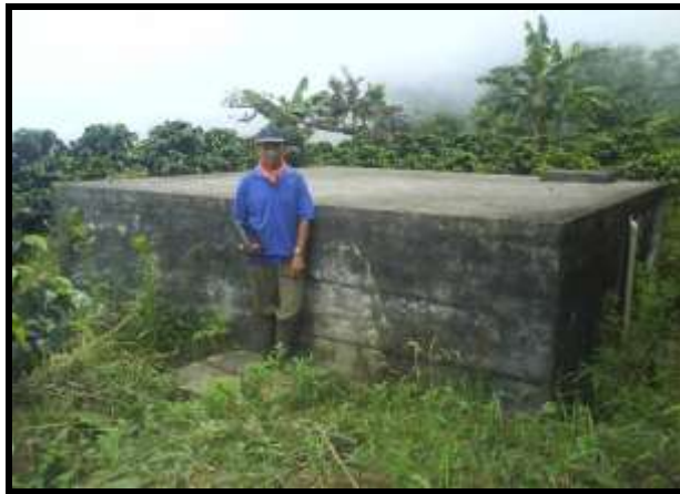
Figura 157 Tanque de almacenamiento
