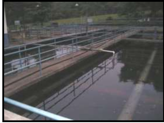
Figura 169 Planta de Tratamiento Acueducto Garzón
