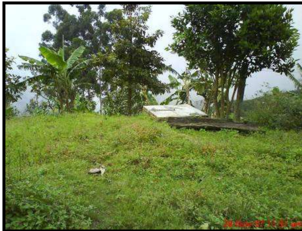
Figura 136 Cámara de quiebre de presión en el tramo de conducción.
