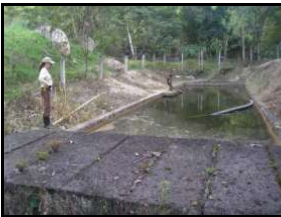
Figura 164 Tanque Sedimentador Acueducto Garzón
