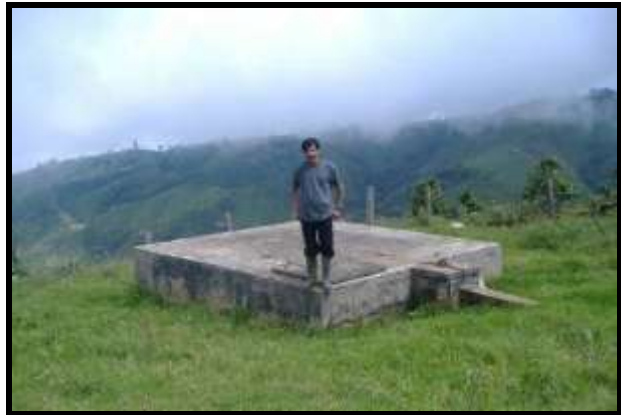
Figura 143 Tanque de Almacenamiento provee agua a las veredas de San José y La Floresta
