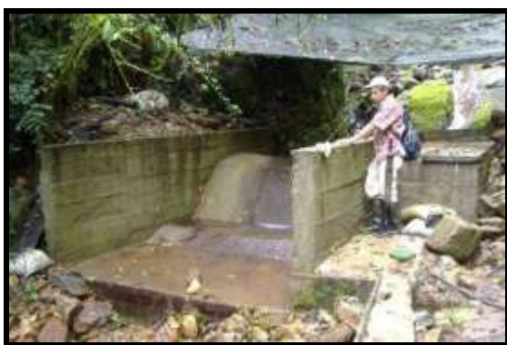
Figura 132 Bocatoma de fondo ubicada en la parte alta de la quebrada Agua Blanca.
