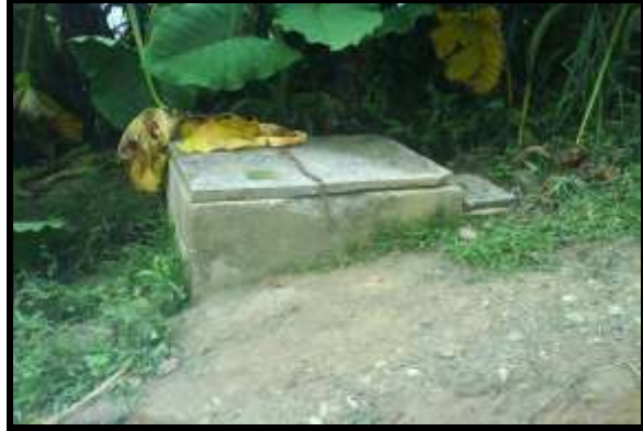
Figura 156 Cámara de quiebre de presión.
