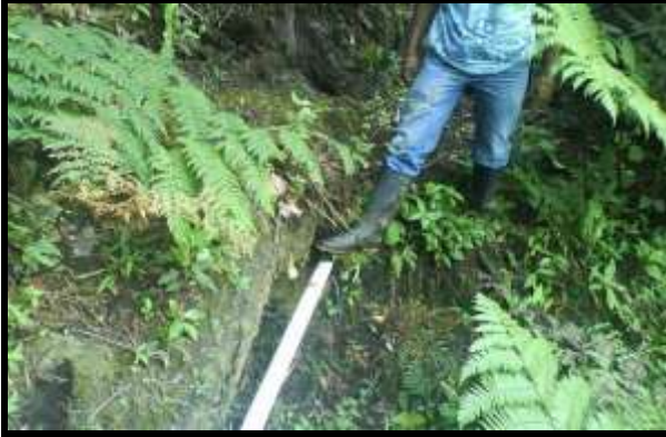
Figura 155 Detalle de tubería de conducción a la vista.
