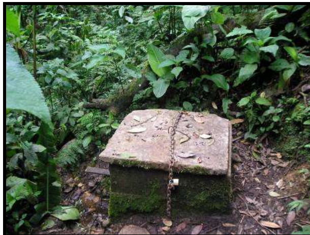
Figura 129 Estructura de quiebre de presión del Sistema 2 quebrada San Benit
