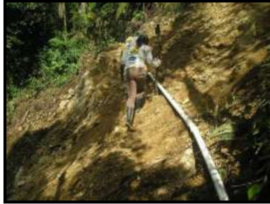
Figura 128 Tubería de conducción hacia Tanque de almacenamiento Quebrada San Benito
