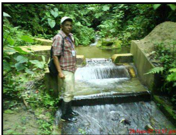
Figura 137 Bocatoma Quebrada de Paramillo
