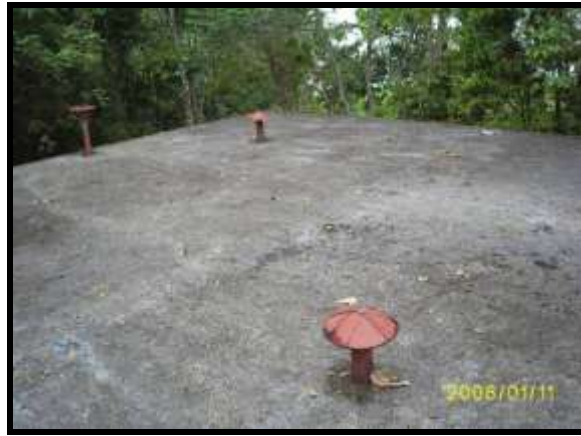
Figura 151 Detalle de ductos de aireación y una rueda control de compuerta.
