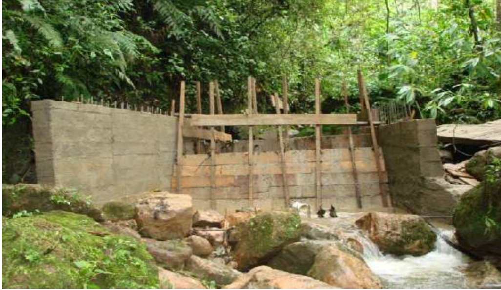
Figura 45. Bocatoma quebrada El Olicual, municipio de Elías Tomado del Plan de Manejo de la Quebrada Olicual - Municipio de Elías
