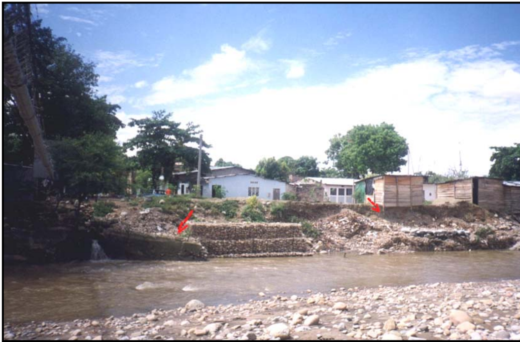
Figura 6.5.4.11. Proceso de socavación lateral en la margen izquierda del río Las Ceibas, al frente del barrio Los Cárbulos, evidenciado por el estado de las obras de contención y de las viviendas subnormales.
