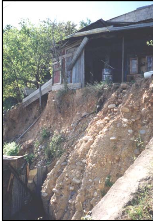
Figura 6.5.4.10. Formación de surcos en el talud del barrio Veinte de Julio; el carácter deleznable del material y la ausencia de cobertura vegetal facilita la acción del agua generando surcos y cárcavas que pueden afectar la infraestructura aledaña.
