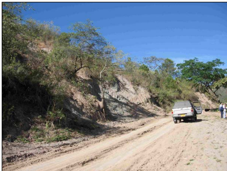
Figura 6.5.4.5. Deslizamientos y erosión remontante en la forma de cárcavas locales, desencadenado por la construcción de la carretera y la falta de una cobertura vegetal, próximos a la finca San Miguel.
