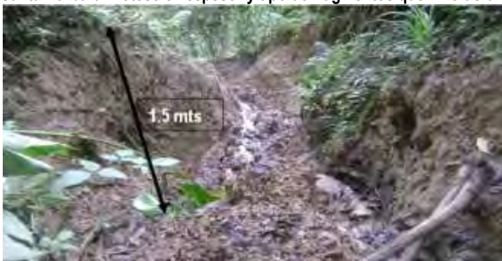
Figura 179. Diagrama de los deslizamientos translacionales que se presentan en el sector de Palestina – Vereda Santa Bárbara. Nótese el espesor y tipo de fragmentos que involucra el movimiento.
