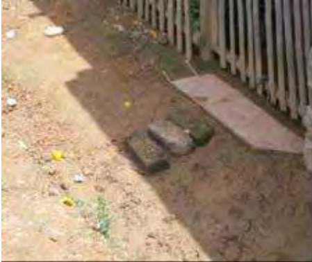
Figura 27. Alcantarillado El Cartucho
