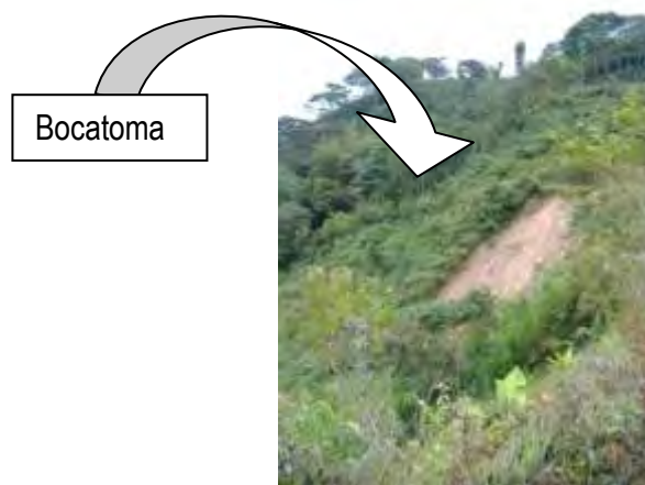
Figura 167. Deslizamientos ocasionados por infiltraciones de la bocatoma del acueducto – Vda Corinto
