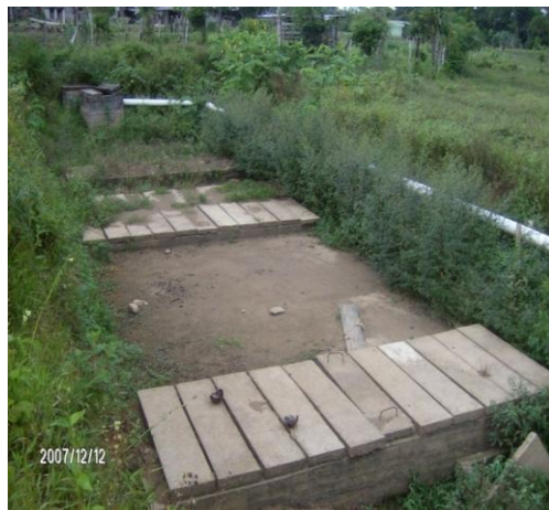
Figura No 39. Recolector de aguas residuales Santiago de la Selva
