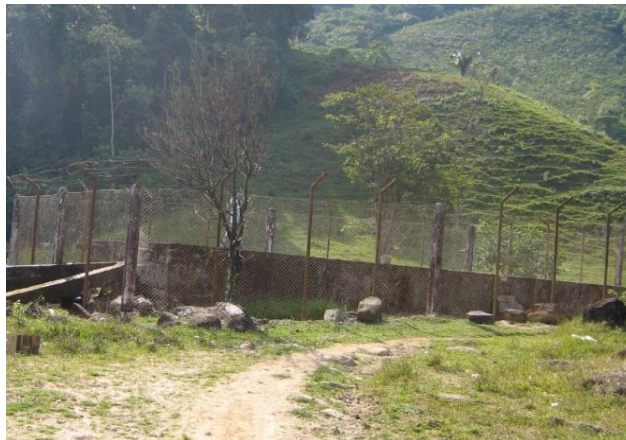
Figura 28: Desarenador quebrada Las Damas
