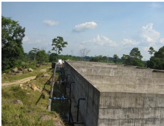
Figura 29: Planta de Tratamiento quebrada Las Damas
