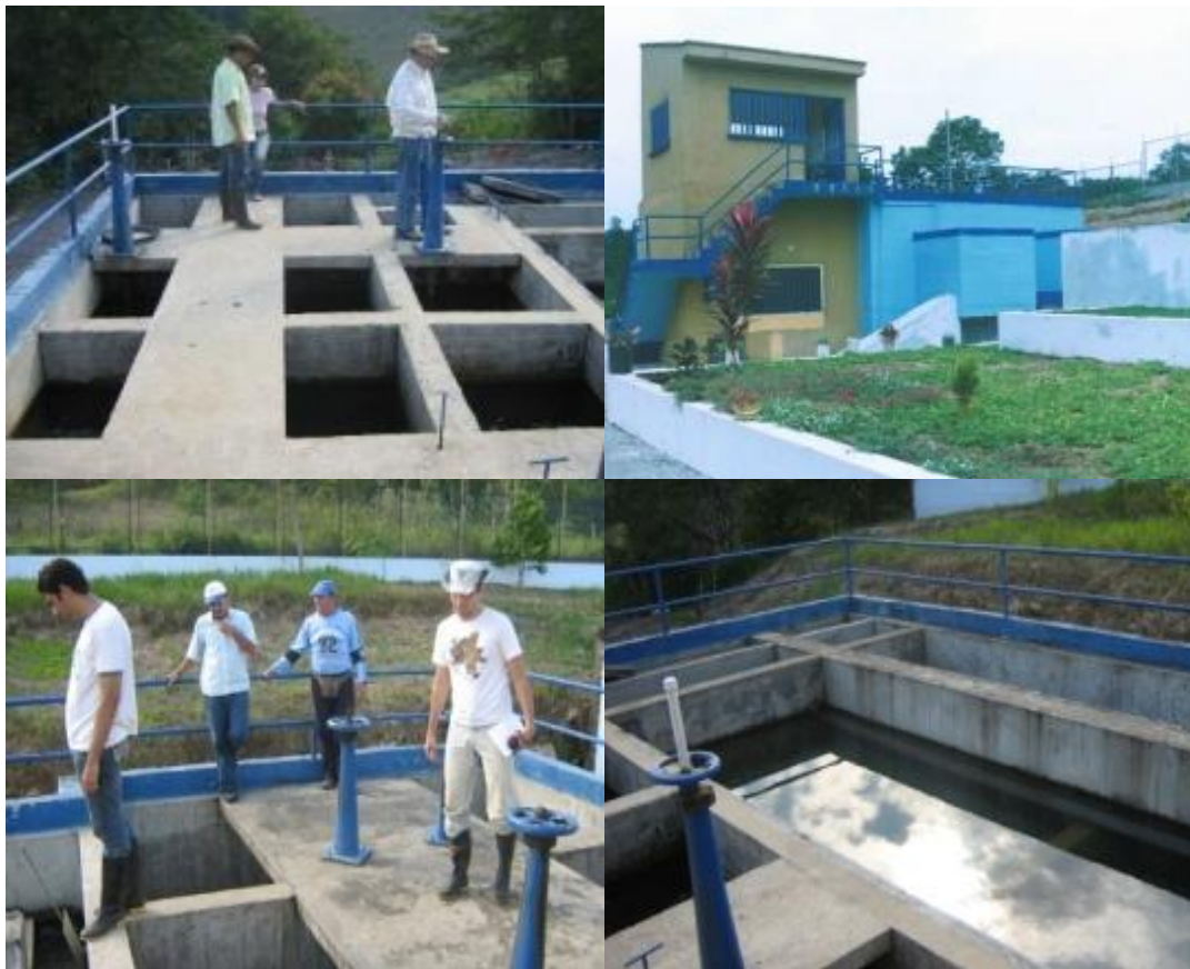
Figura 31: Planta de Tratamiento quebrada La Borugo
