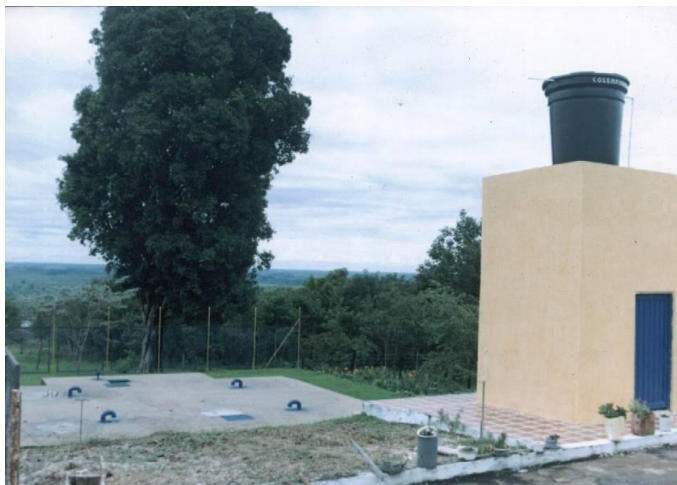
Figura 32: Tanque de Almacenamiento
