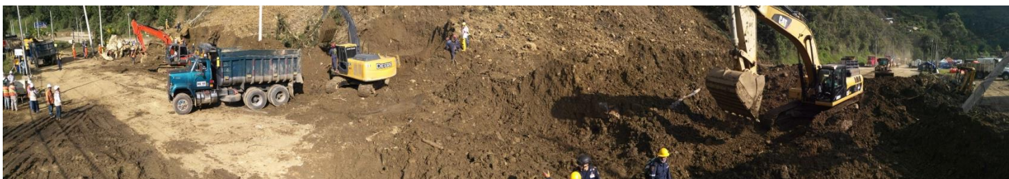
Imagen No 4: Remoción del material en la calzada descendiente de la vía Medellín – Bogotá Fuente Imagen: UNGRD
