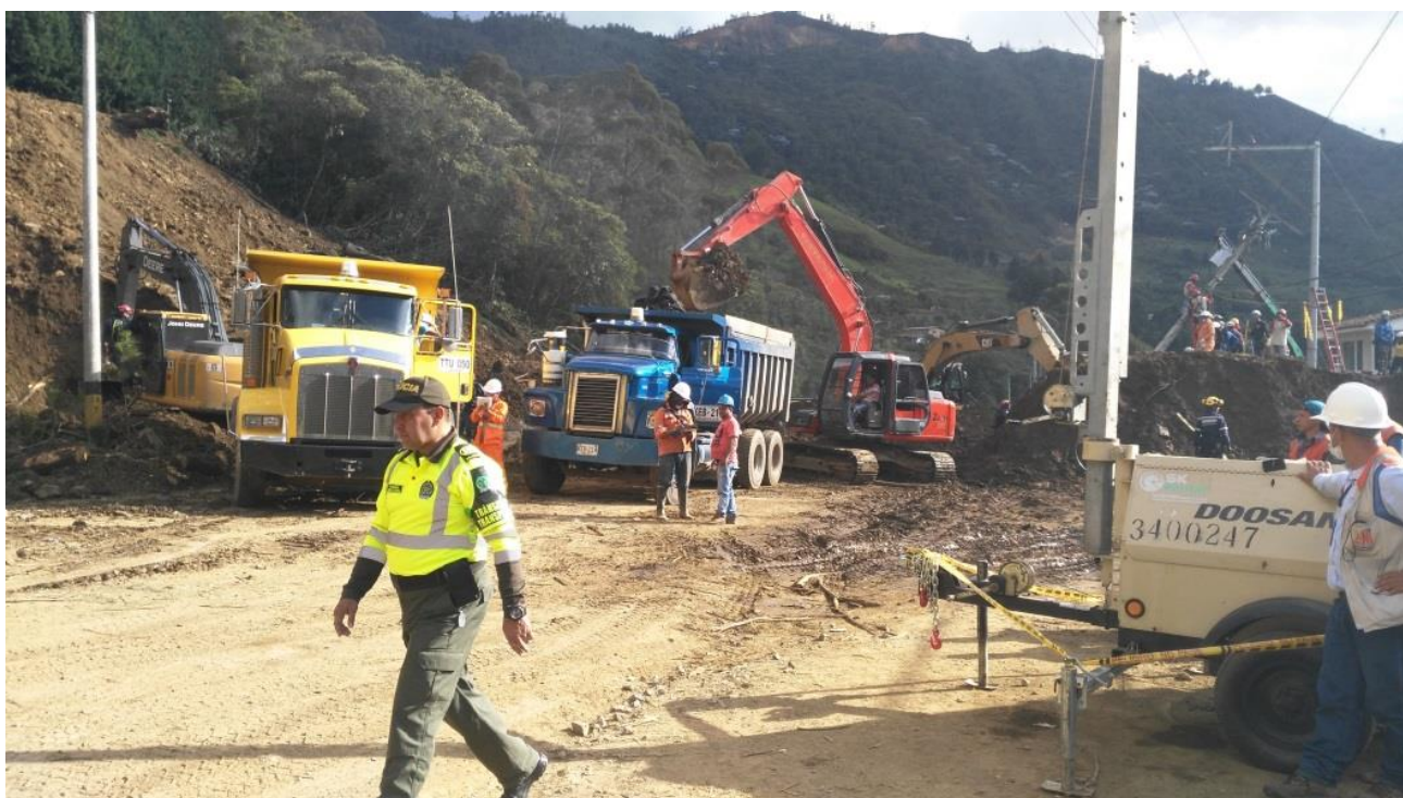
Imagen No 5: Remoción del material en la calzada descendiente de la vía Medellín – Bogotá Fuente Imagen: UNGRD
