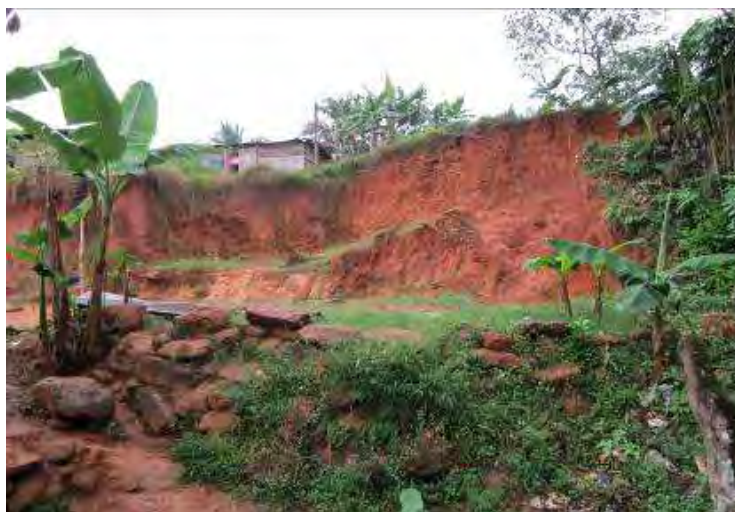
Figura 2- 12 Intervención antrópica en cortes, sector la colina. Fuente: propia
