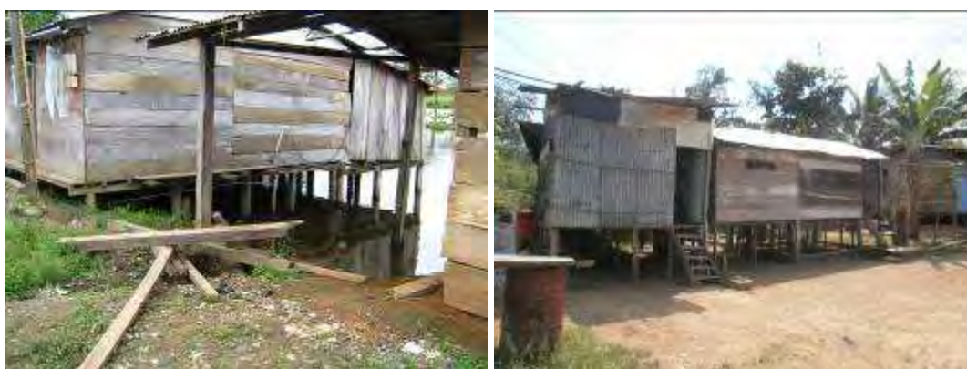
Figura 4- 18 Cimentación Palafítica de algunas viviendas cercanas a la margen del Caño el Indio. La vivienda de la izquierda esta invadiendo el cauce.
