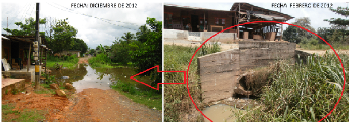
Figura 4- 31 Obras de arte que hacen parte de la infraestructura vial de la calle 6 a la altura de la carrera 11, frente a la ebanistería, donde en época invernal la alcantarilla no es funcional e impide el uso de la vía que conduce del Centro a barrios como El Progreso y 4 de Agosto.
