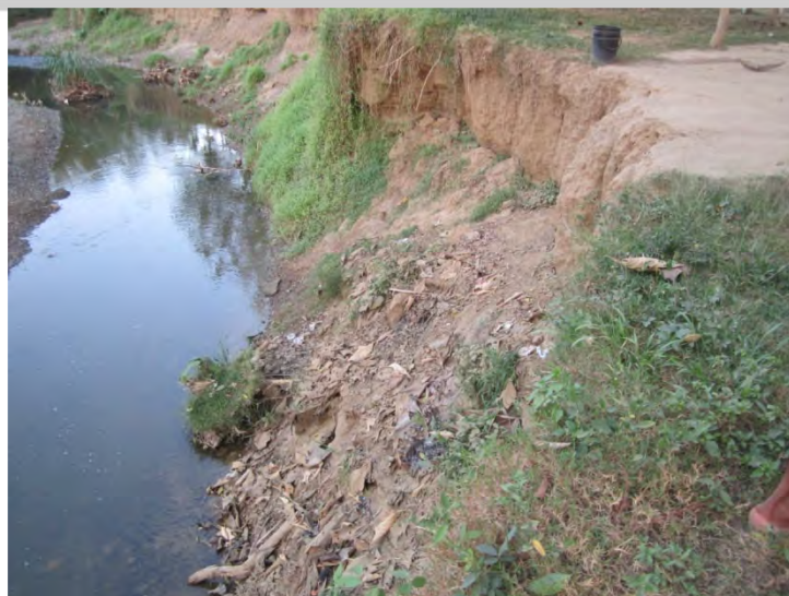
Figura 3- 8 Detalle de proceso activo en la margen derecha del río San Juan, pérdida de material evidente.
