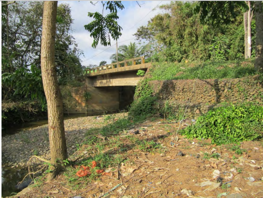
Figura 3- 13 Socavación lateral en cercanías a puentes. Se han realizado algunas obras de contención y mitigación como gaviones.
