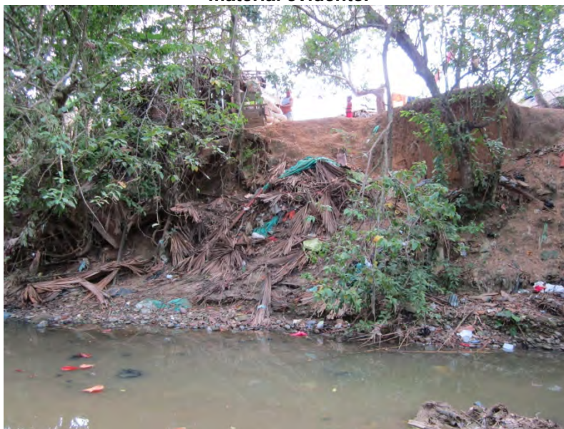
Figura 3- 9 Proceso activo en la margen derecha de la quebrada el Pirú, pérdida de material y caída de vegetación.
