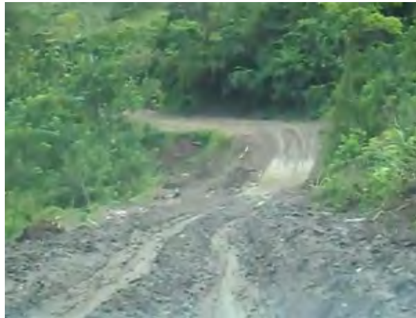
Figura 4- 27 Estado de la Vía San Pedro – El Tres en el Alto de los Mulatos.
