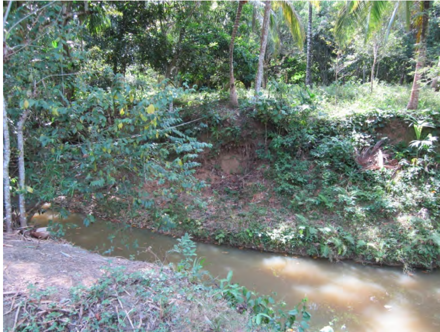
Figura 3- 12 Proceso incipiente en la margen derecha de la quebrada El Pirú, pérdida de material y vegetación por intervención antrópica.
