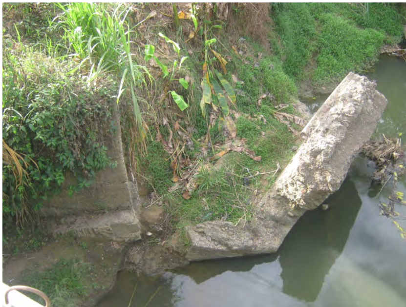
Figura 3- 14 Socavación lateral en cercanías a puentes. Afectación a las aletas de los estribos.
