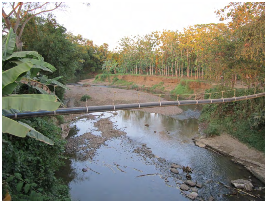
Figura 3- 7 Proceso activo en la margen derecha del río San Juan, pérdida de material evidente.
