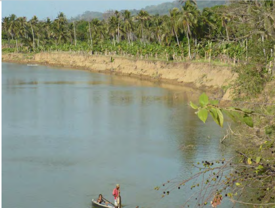
Figura 3- 4 Aspecto general de la terraza T1, periódicamente inundable, se aprecia la socavación severa de sus márgenes.
