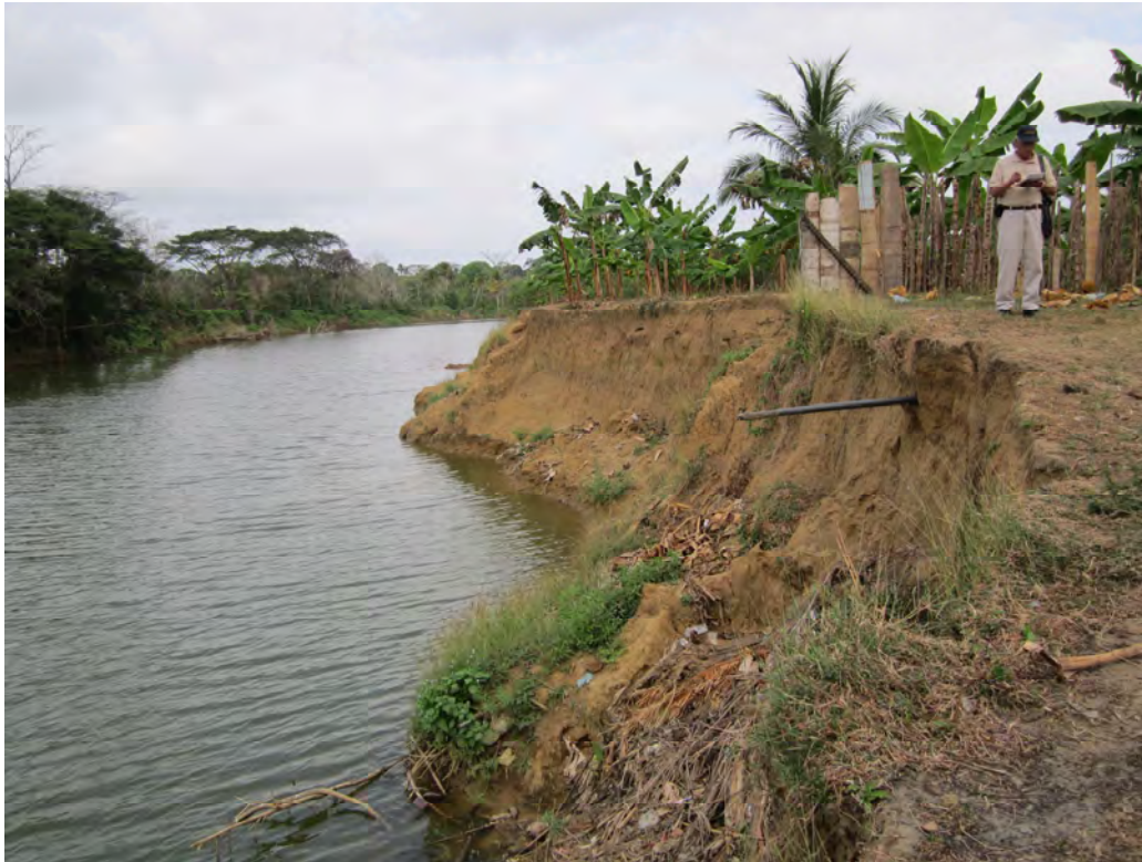
Figura 3- 7 Erosión lateral de márgenes.
