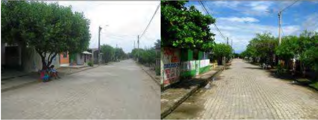
Figura 4- 25 Estado de las vías
