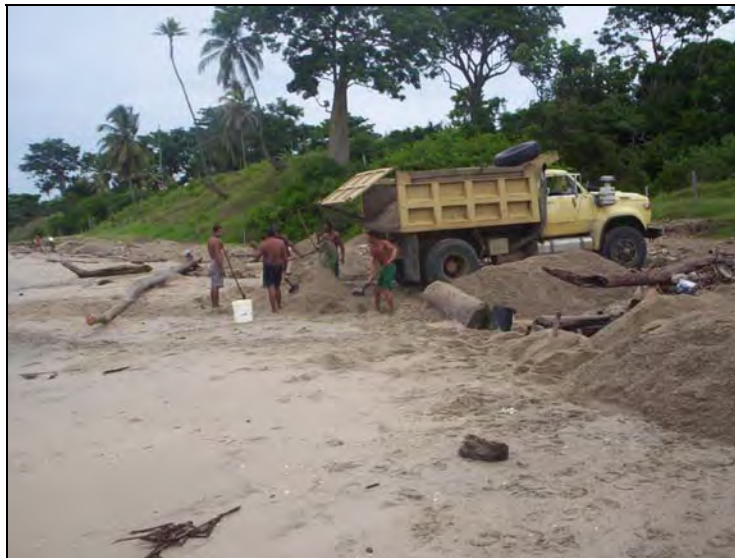
Figura 3.30. Extracción intensiva de materiales de playa en la playa del río Jobo
