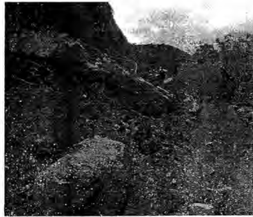
FOTO2. ESTADO DE LA VIA A 1KM VEREDA PICUMA MPIO SUAZA -HUILA.
