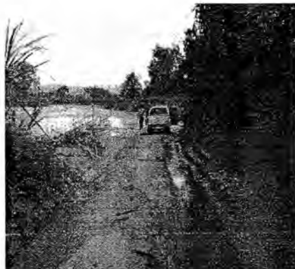
FOTO 9. ESTADO DE LA VIA CIENAGA EL RINCON.
