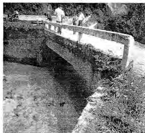
Foto 12. Sedimentos Bajo Puente CH. R.
