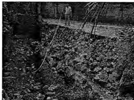
FOTO 1. AFECTACIÓN CANAL 1 BARRIO PUEBLO NUEVO CASCO URBANO BARAYA
