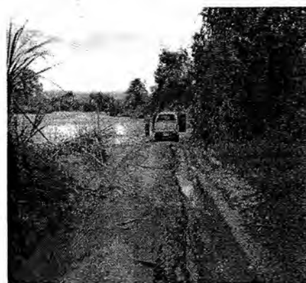
FOTO 9. ESTADO DE LA VIA CIENAGA EL RINCON.
