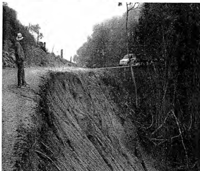
FOTO 1. ESTADO DE LA BANCA VIA BATAN- MUNICIPIO DE ALGECIRAS
