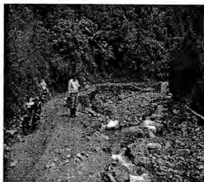
Foto1. Estado de la Banca Vía Vereda Las Juntas Cruce Sixta.
