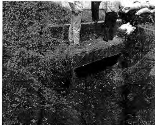
FOTO 3. REDUCCION DE LA SECCION HIDRAULICA CANAL 1 BARRIO PUEBLO NUEVO MPIO BARAYA-HUILA.
