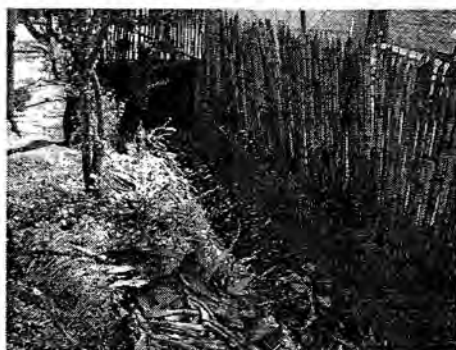
FOTO 3. AFECTACIÓN CANAL 2 BARRIO PUEBLO NUEVO CASCO URBANO BARAYA
