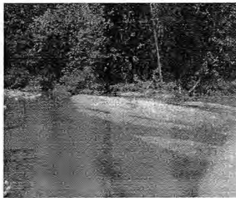
Foto 8. Quebrada Guaroco Susceptible a desbordamiento.
