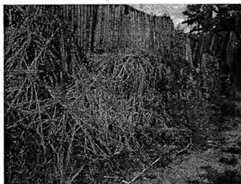
FOTO 3. MURO GAVION BARRIO AMAPOLITA CASCO URBANO MUNICIPIO DE HOBO.
