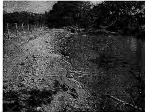
FOTO 2. ESTADO DE LA VIA PASO EL IGUA
