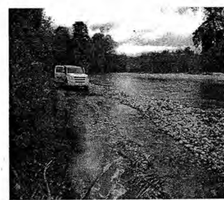
FOTO 10. ESTADO DE LA VIA PASO EL IGUA
