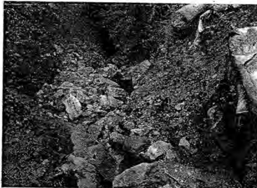
FOTO 5. AFECTACION AGUAS ABAJO QDA TRIGEÑA
