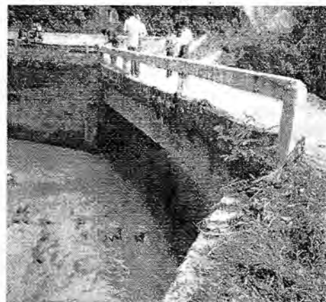
Foto 12. Sedimentos Bajo Puente CH. R.
