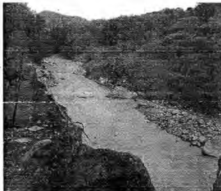
FOTO 1. DESLIZAMIENTO MARGEN DERECHA AGUAS ARRIBA RIO TIMANA
