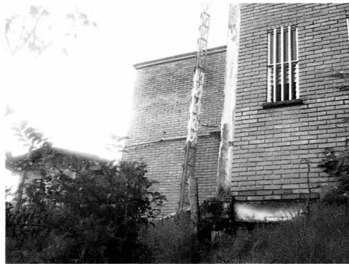
INMEDIANTAMENTE DETRÁS DE TELECOM – TALUD VIA AL BRILLANTE (FOTO 1)
